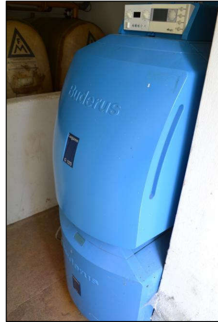
Bild 32: Heizungsraum mit Öltanks
