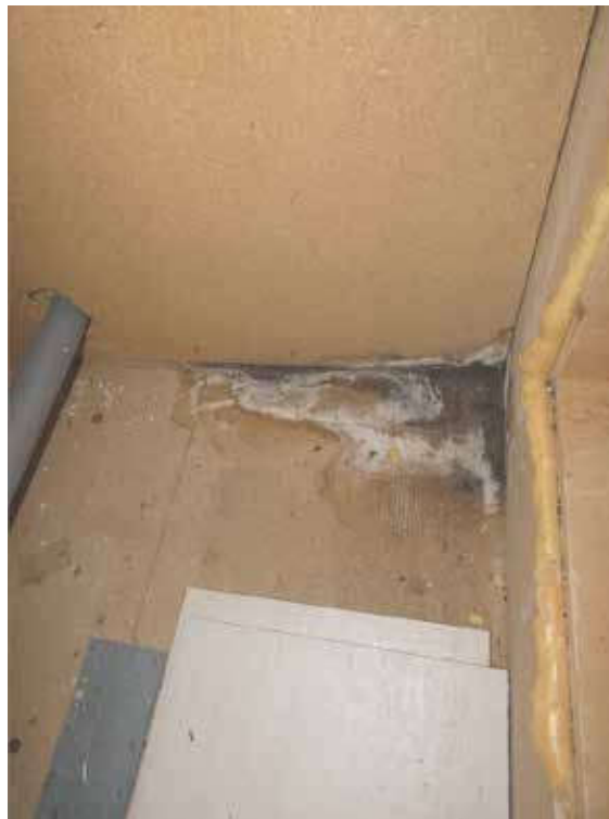
Bild 8: Wasserschaden im Dachgeschoss (hinter Wandverkleidung)
