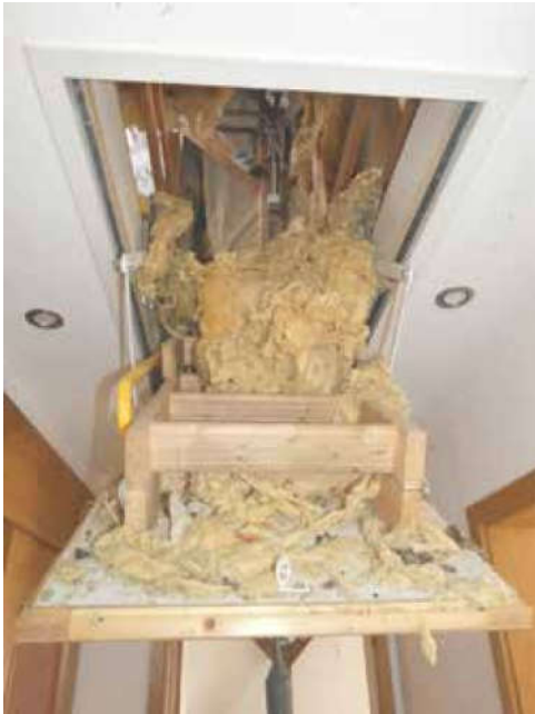
Bild 21: Zugang zum Spitzboden (mit defekter Dachdämmung)
