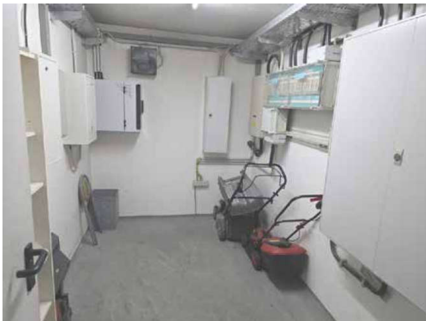
Bild 14: Medienanschlussraum (Keller im Haus Berliner Straße 20a)
