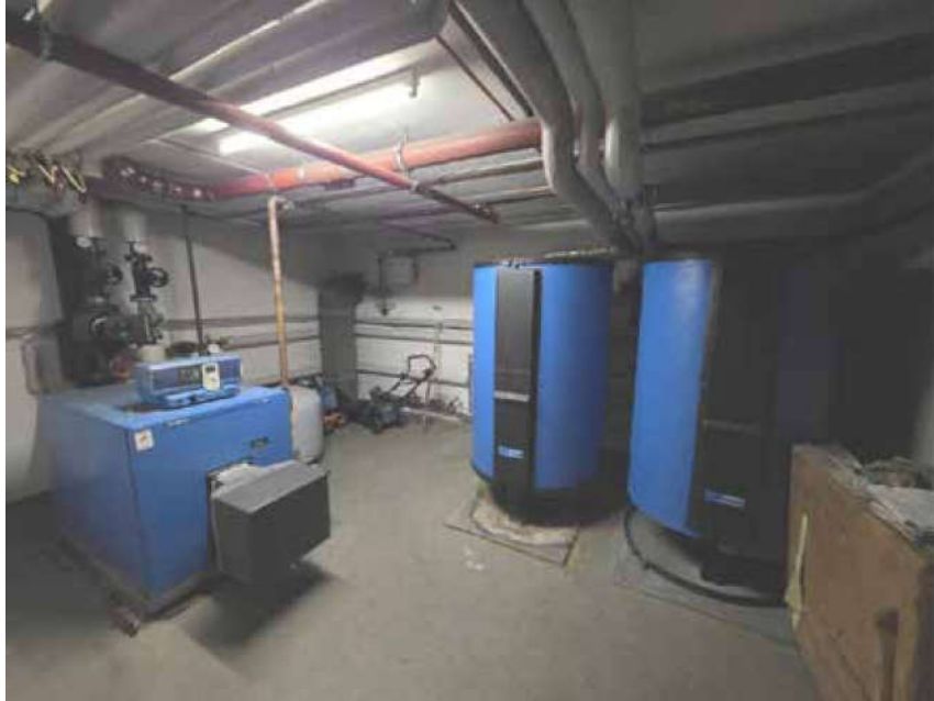
Bild 13: Heizungsraum (Keller im Haus Berliner Straße 20a)
