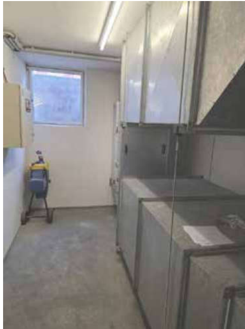
Bild 15: Technikraum zu Tiefgarage (Keller im Haus Berliner Straße 20a)
