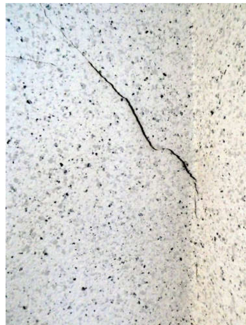
Bild 20: Nr. 24: Treppenhaus Rissbildung Wandbereich
