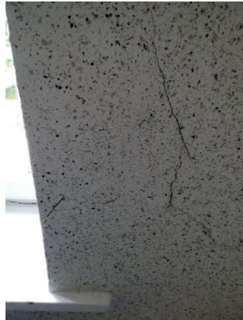
Bild 30: Nr. 22: Treppenhaus Rissbildung Wand
