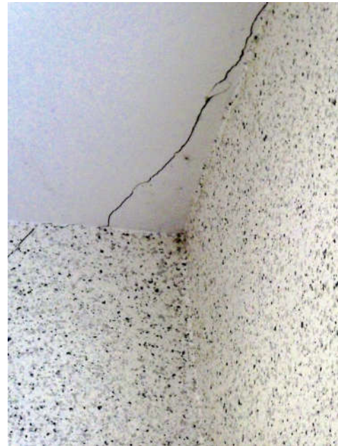
Bild 22: Nr. 24: Treppenhaus Rissbildung Deckenbereich
