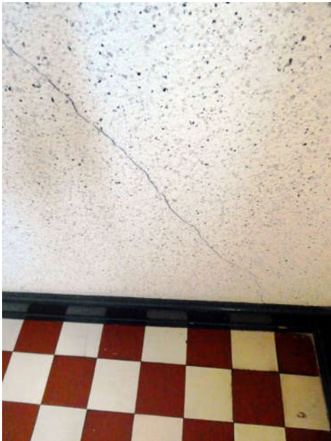
Bild 21: Nr. 24: Treppenhaus Rissbildung Wandbereich
