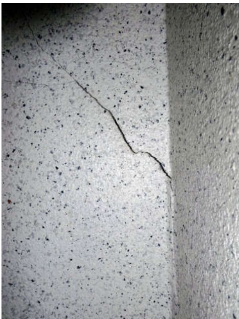
Bild 23: Nr. 24: Treppenhaus Rissbildung Wandbereich
