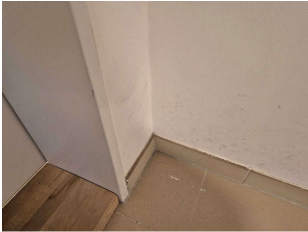
gerissene Dehnungsfugen im Treppenhaus
