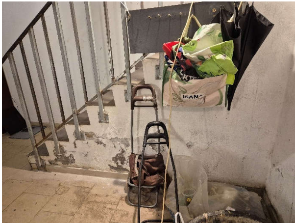
Ausblühungen an der Treppenwange
