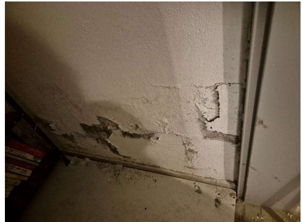
Ausblühungen an der Kellerwand
