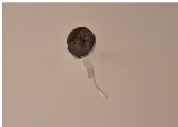
Deckenauslass in Wohnung 4
