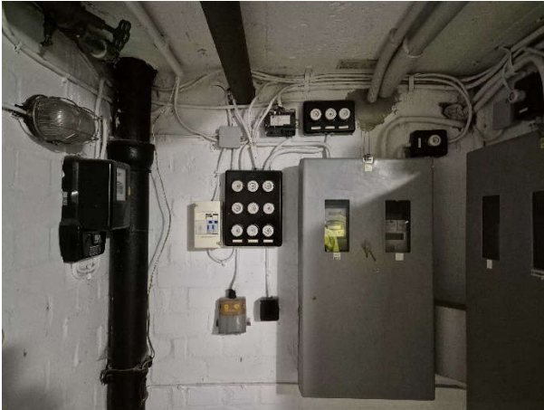
Sicherungsverteilung im Keller
