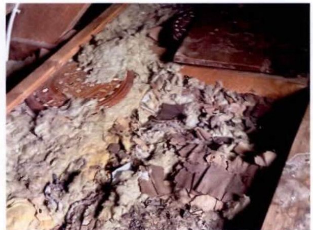
Spitzboden Fußbodendämmung überaltert
