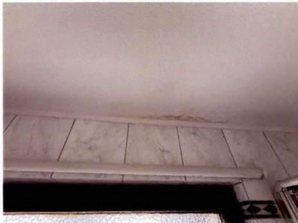
Vollbad – Feuchtesignatur über dem Fenster
