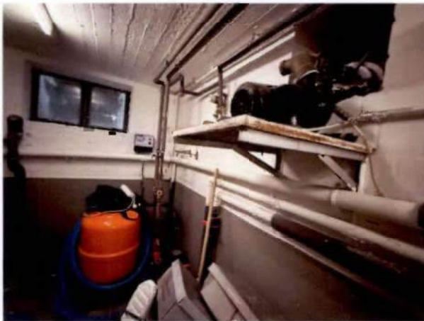
Installationsraum – weitere technische Anlagen
