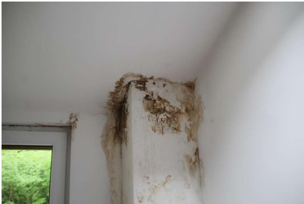
Feuchtigkeitsschaden am Schornsteinzug
