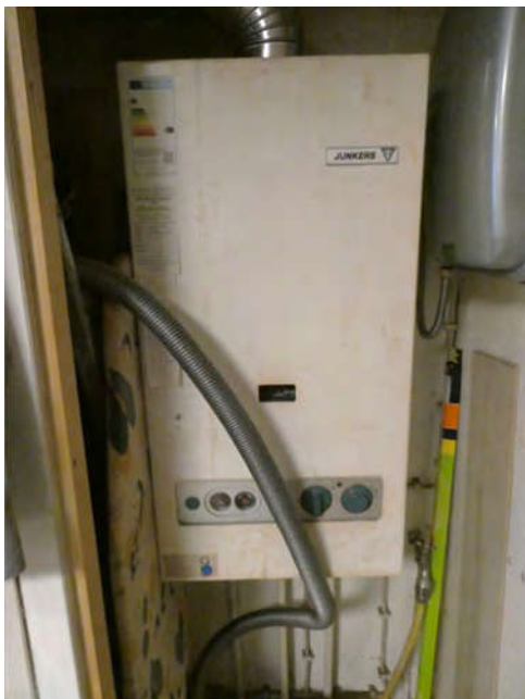
Bild 18: Whg Nr. 58a: Heizungsanlage
