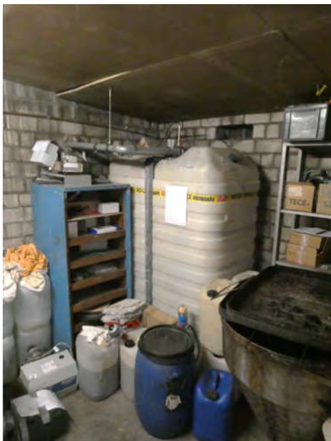
Bild 43: Werkstattgebäude , Kunststoffank Heizung
