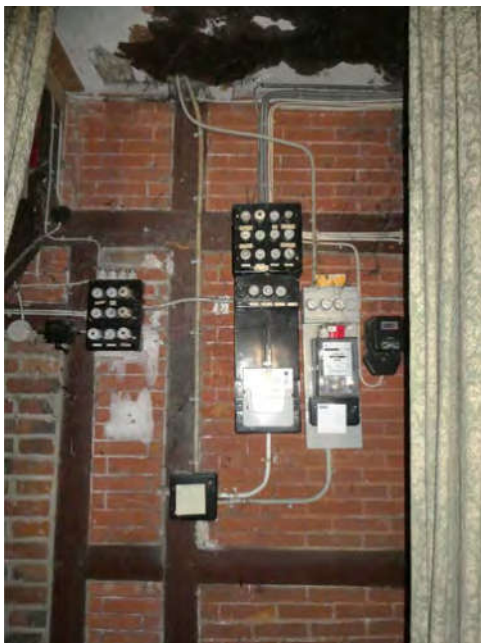
Bild 63: Abstellbereich Diele / Situation Elektrik
