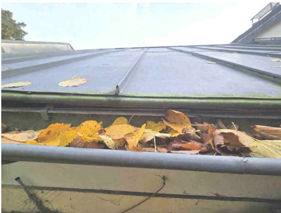
↑ Bild 34: aufgequollenes Schichtholz der Dachschalung
