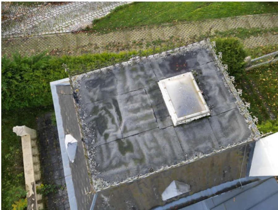
↑ Bild 38: schadhafte Dacheindeckung auf dem Kesselhaus
