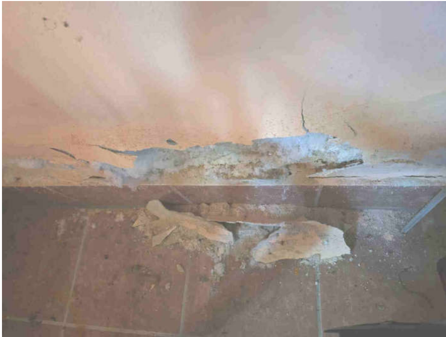
↑ Bild 37: aufsteigende Feuchtigkeit mit massiven Putzschäden (Westflügel)
