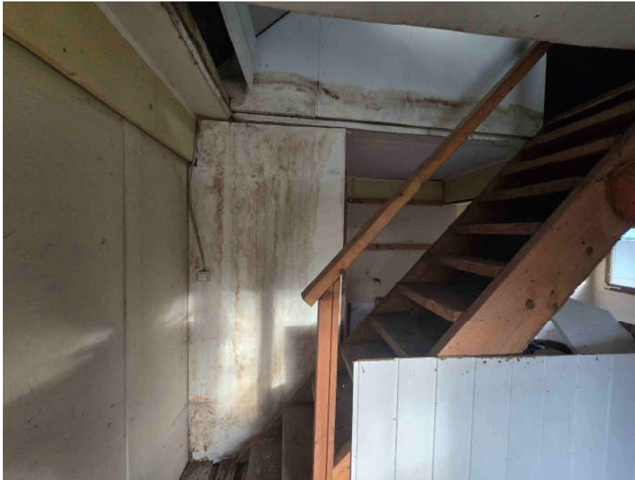
↑ Bild 43: Wasserschaden im Nebengebäude
