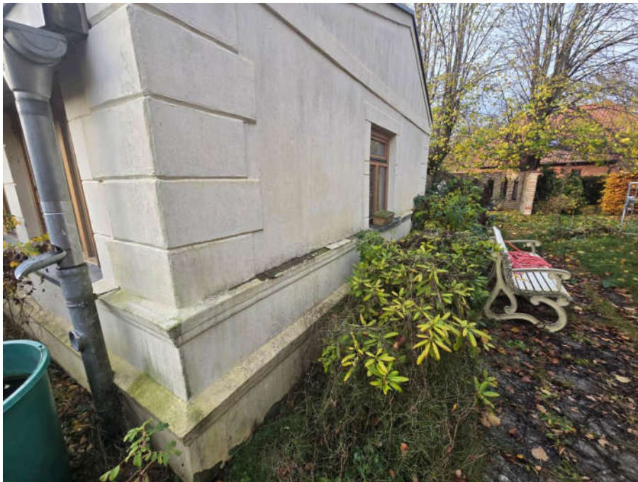
↑ Bild 33: Putzschäden am Ostgiebel
