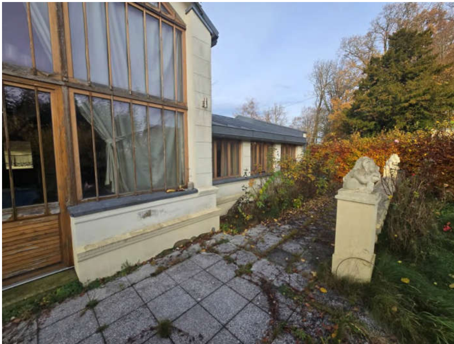
↑ Bild 31: Schäden am Außenputz
