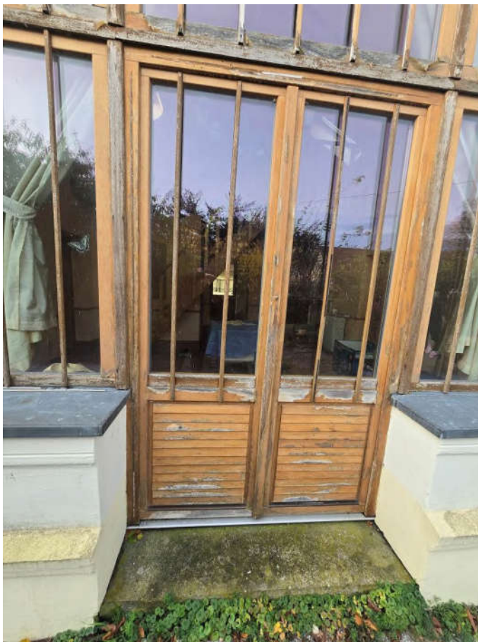
↑ Bild 32: Stark verwitterte Türen und Fenster am Glashauss
