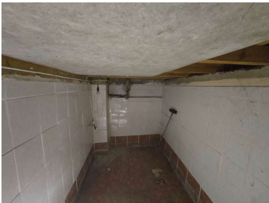
↑ Bild 25: Teilkeller im Kesselhaus
