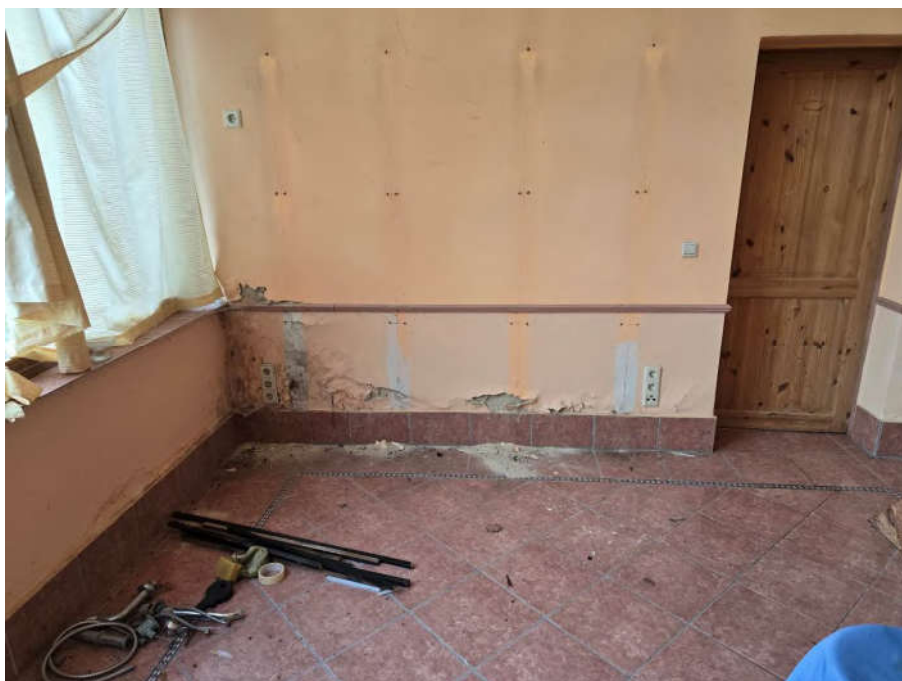
↑ Bild 35: aufsteigende Feuchtigkeit mit massiven Putzschäden (Ostflügel)
