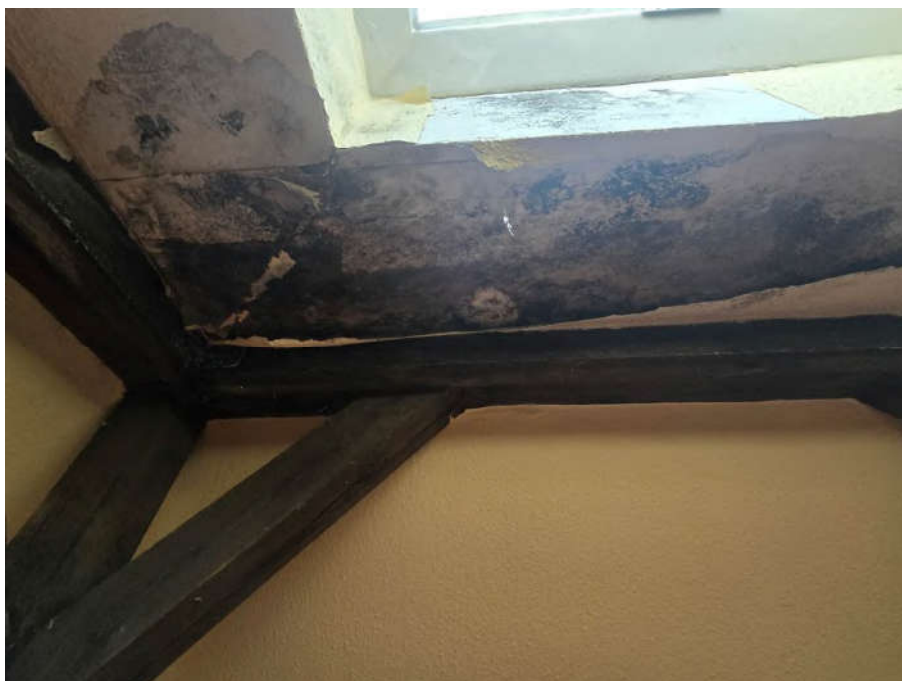
↑ Bild 28: undichte Einpassung der Lichtkuppel mit massiven Feuchteschäden
