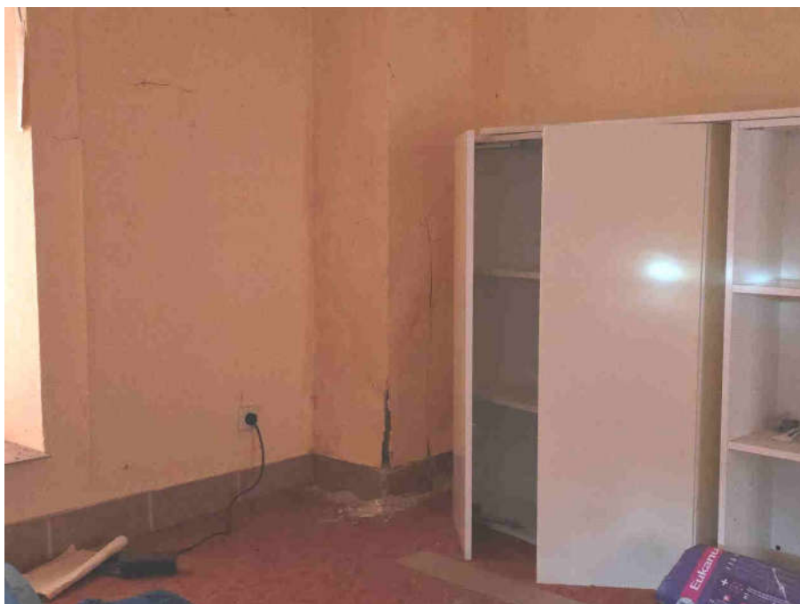
↑ Bild 36: aufsteigende Feuchtigkeit mit massiven Putzschäden (Kesselhaus)
