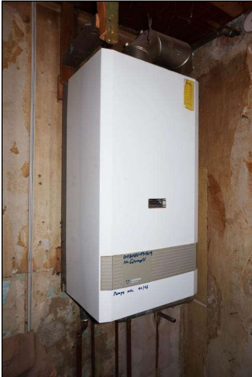
Blick auf die ehem. Zentralheizung (Funktionsfähigkeit wird nicht unterstellt)
