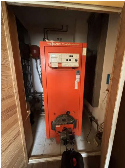
Bild 14: Einfamilienhaus, Heizung EG
