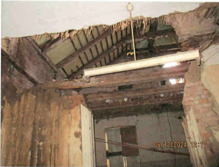
Innenansicht: abgängige Lehmdecken
