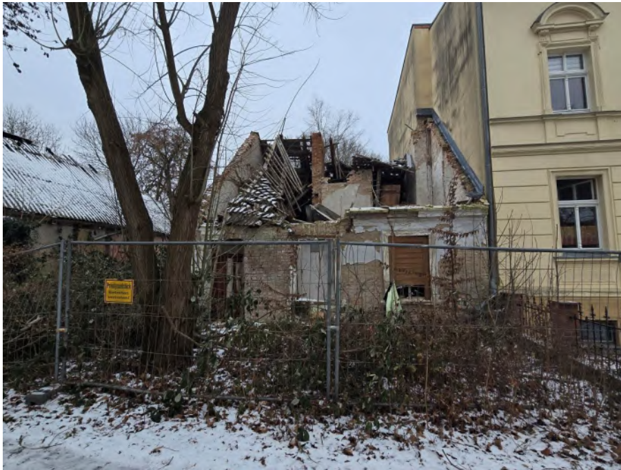
↑ Bild 3: Ruine des ehemaligen Kutscherhauses an der östlichen Grundstücksgrenze
