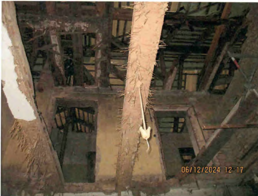
Blick in den Dachraum: fehlende Lehmdecken
