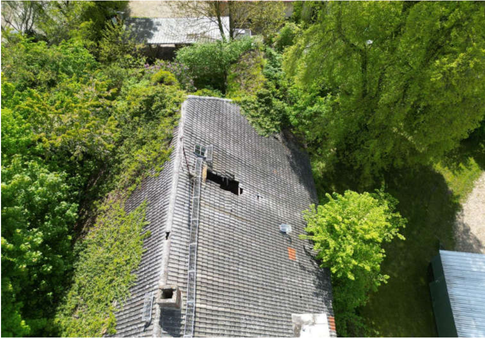
↑ Bild 15: Blick auf den schadhaften Bereich des Daches
