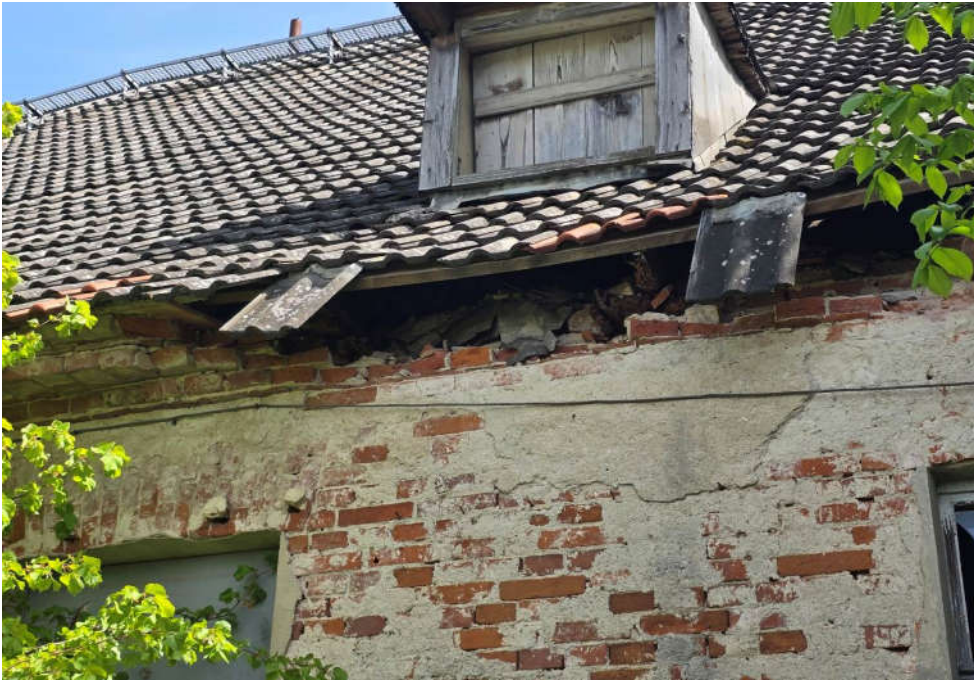
↑ Bild 11: diverse Schadensbilder
