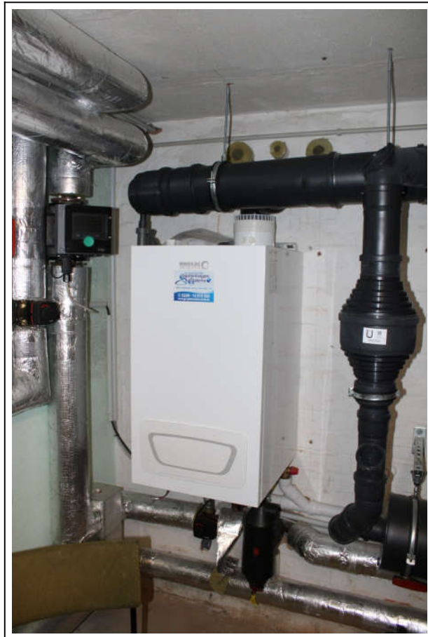
Foto 9 Ansicht der vorhandenen Gasheizungsanlage
