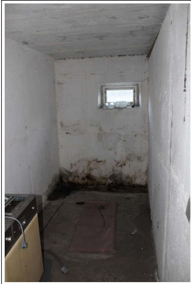
Foto 13 Beispielansicht von Feuchtigkeitsschäden an Außenwandbereichen im KG
