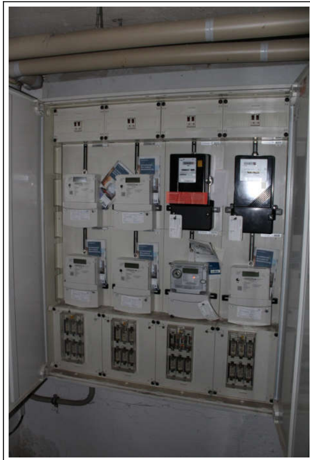
Foto 11 Beispielansicht Zähler- schrank im Kellergeschoss
