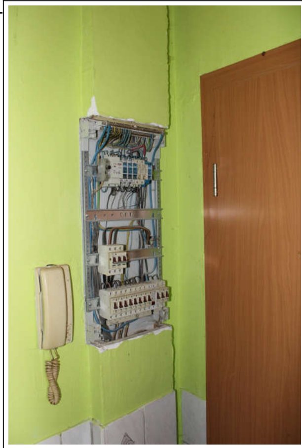
Foto 23 Beispielansicht Sicherungskasten mit alten Zuleitungen sowie eine Wechselsprechanlage in einer Wohnung
