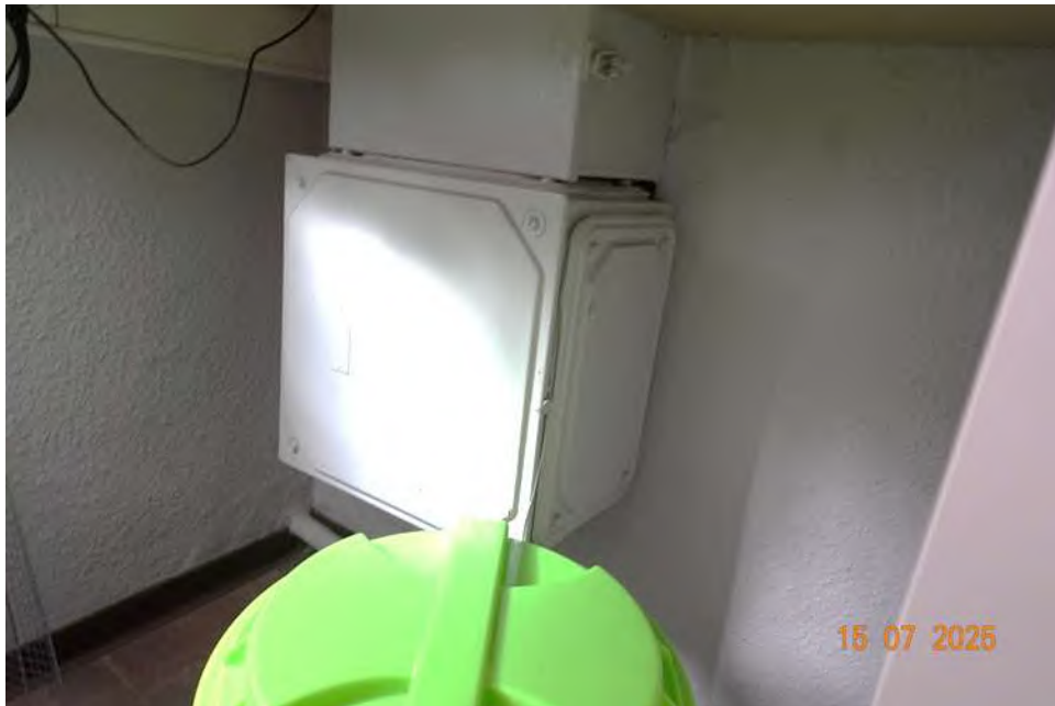
Bild 27: Darstellung es alten E-Hausanschlusses im Werkstattgebäude
