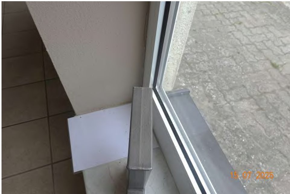
Bild 25: Darstellung der Wanddicke des Werkstattgebäudes zur Straßenfront
