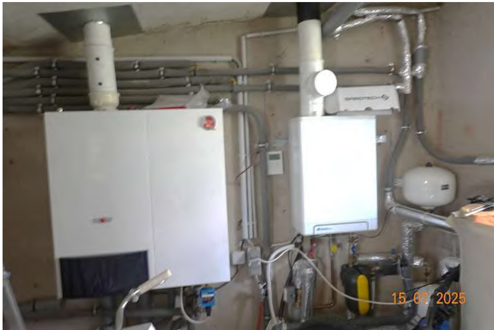
Bild 15: Darstellung der zwei Gas-Heizgeräte für je eine Wohnung des Zweifamilienhauses
