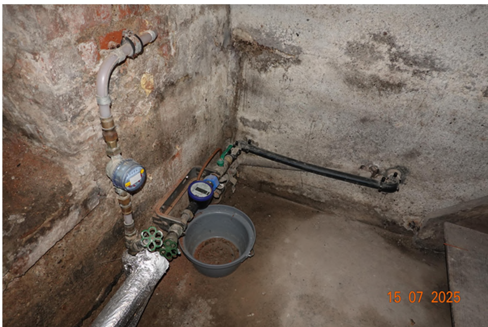
Bild 8: Darstellung des Wasserzählers im Kellergeschoss
