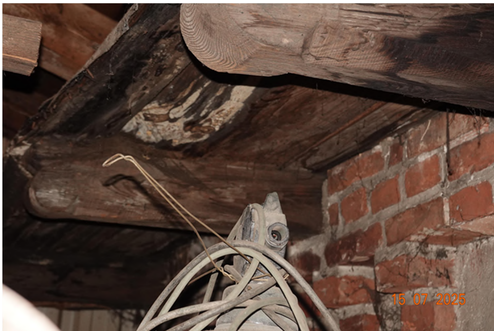
Bild 32: Darstellung von lokalen Anobienbefall im Gebälk der Dachkonstruktion
