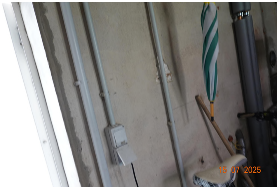
Bild 16: Darstellung der neuen E-Versorgung im Nebengebäude
