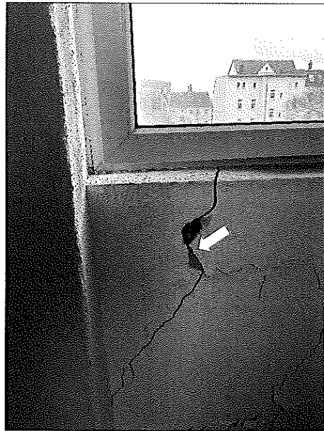
⇒ Spannungsriss im Treppenhaus, ein Beispiel
