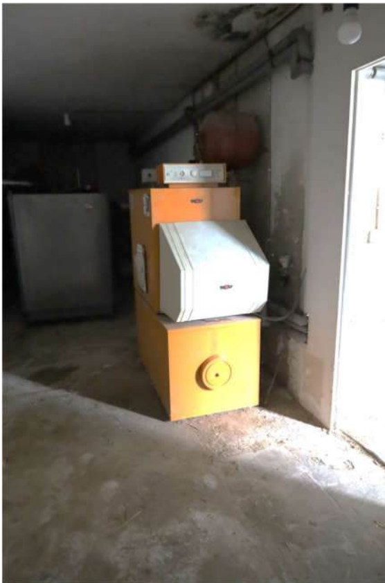
Ölheizungsanlage (ohne Funktion)
