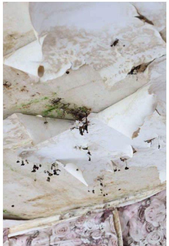
Schadensbild im Deckenbereich
