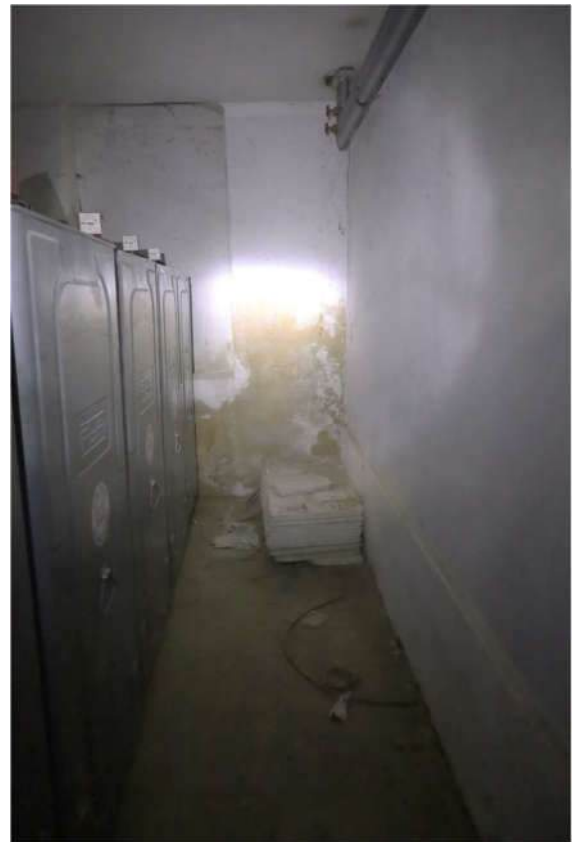
Heizöltanklager (Vorgefundene Schadensbereiche)
