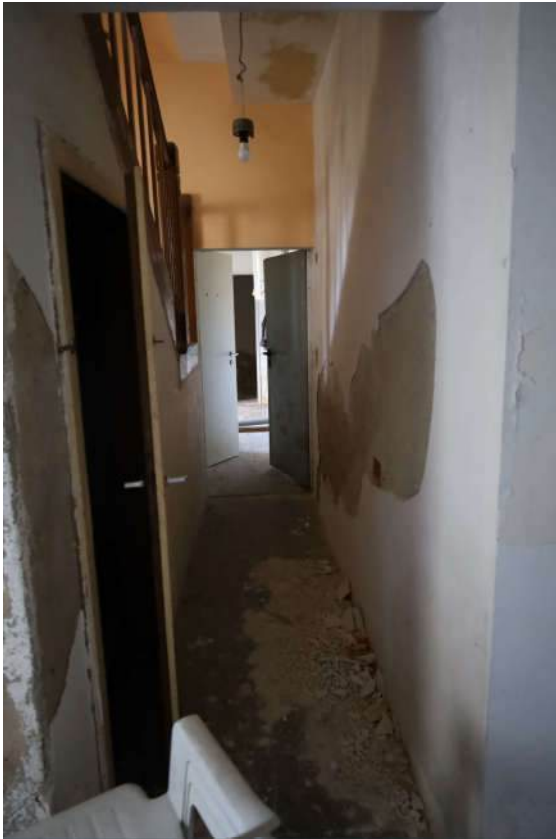
Flurbereich mit großflächigen Sichtschäden
