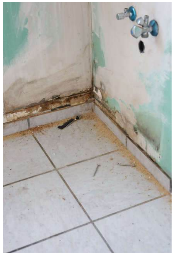
Küche mit Sichtschäden
