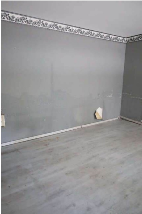
Zimmer (Feuchteschäden im Wandbereich)
