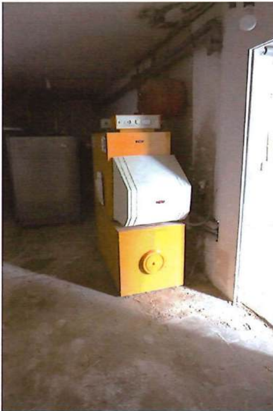
Ölheizungsanlage (ohne Funktion)
