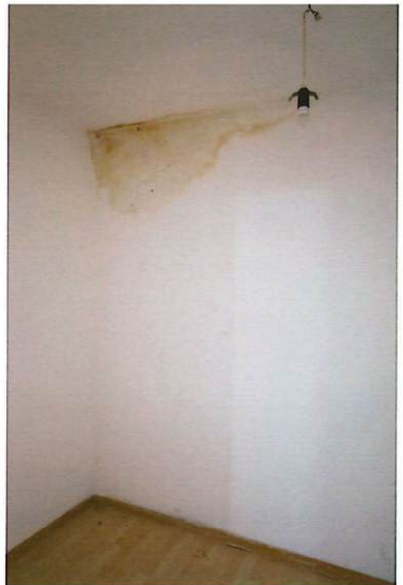
Sichtschäden im Wand-/ Deckenanschluss
