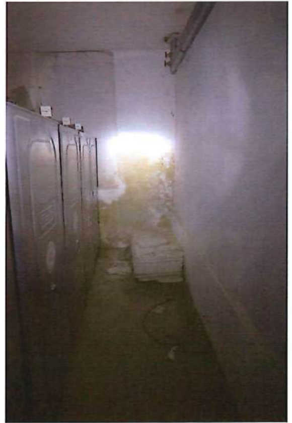
Heizöltanklager (Vorgefundene Schadensbereiche)
