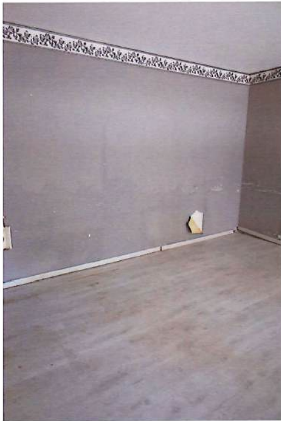
Zimmer (Feuchteschäden im Wandbereich)
