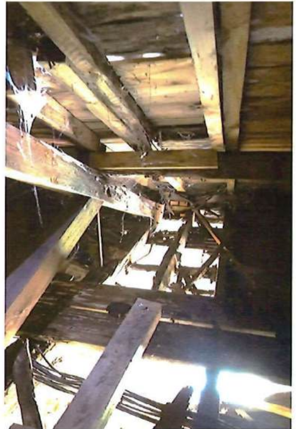
Eingestürzter Teilbereich der Saaldecke
