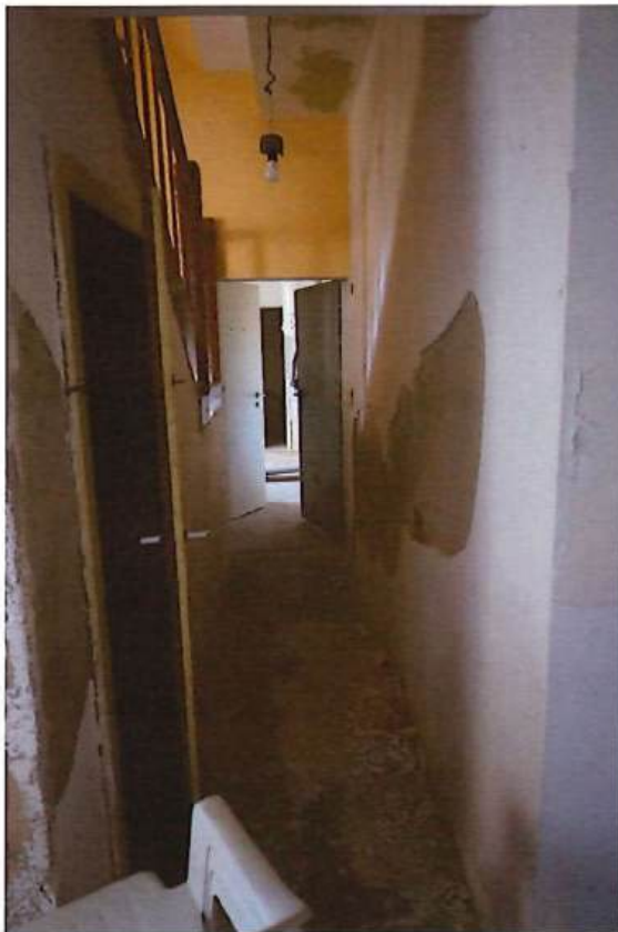
Flurbereich mit großflächigen Sichtschäden
