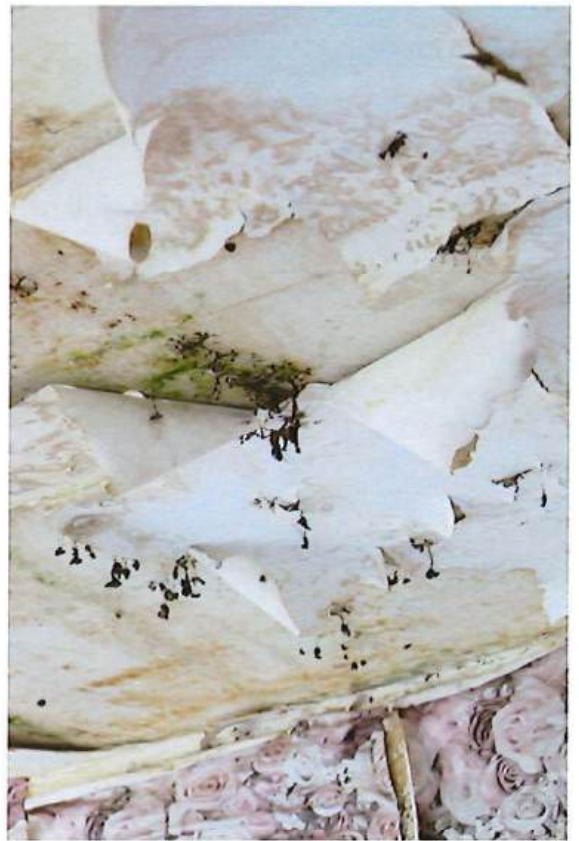
Schadensbild im Deckenbereich
