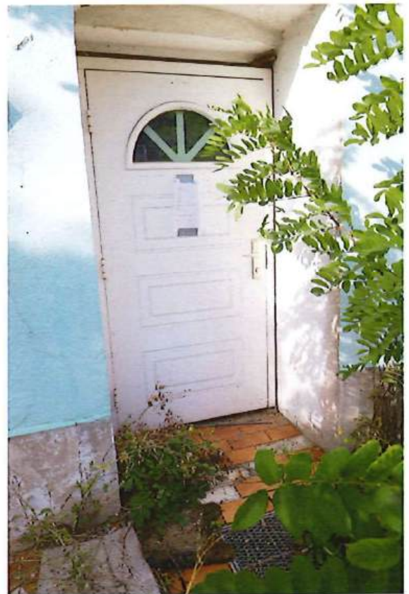
Sichtschäden in dem Eingangspodest
