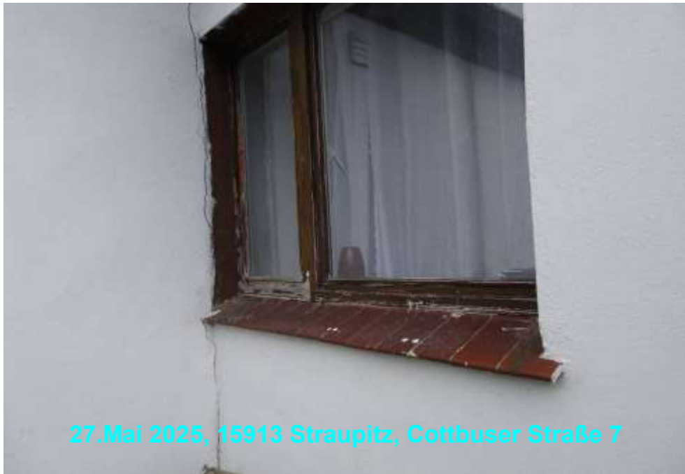
Wohnhaus – Detail zu der Fassade und dem Fenster von der Hofseite [oben Detail zu der Rissbildung zwischen Hauptgebäude und Anbau]
