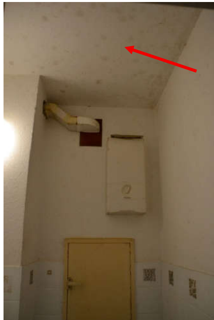
Bild 16: 3. Obergeschoss innenliegendes WC, Schimmelpilzbefall an Decke und Wand
