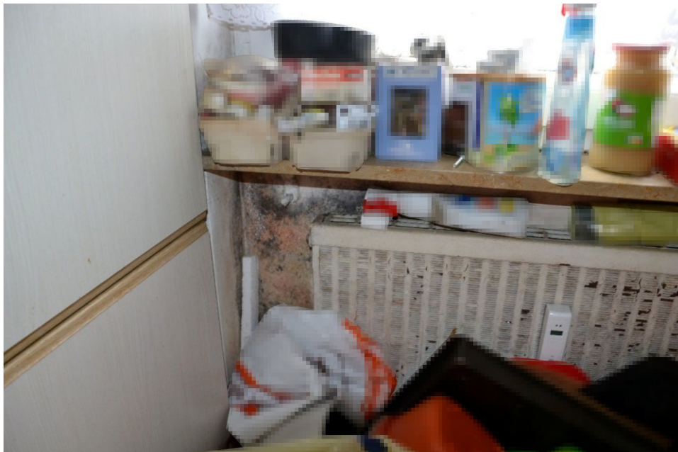
Bild 14: 3. Obergeschoss Küche Schimmelpilzbefall Wand, austauschbedürftiger korrodierter Heizkörper (Rostbildung)
