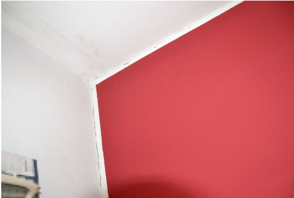
Bild 15: 3. Obergeschoss, Rissbildung an der Decke/Wand
