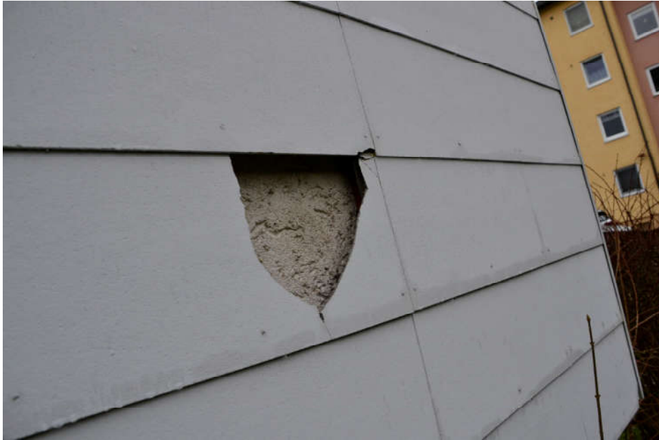
Bild 9: Schäden an der Verkleidung des Westgiebels
