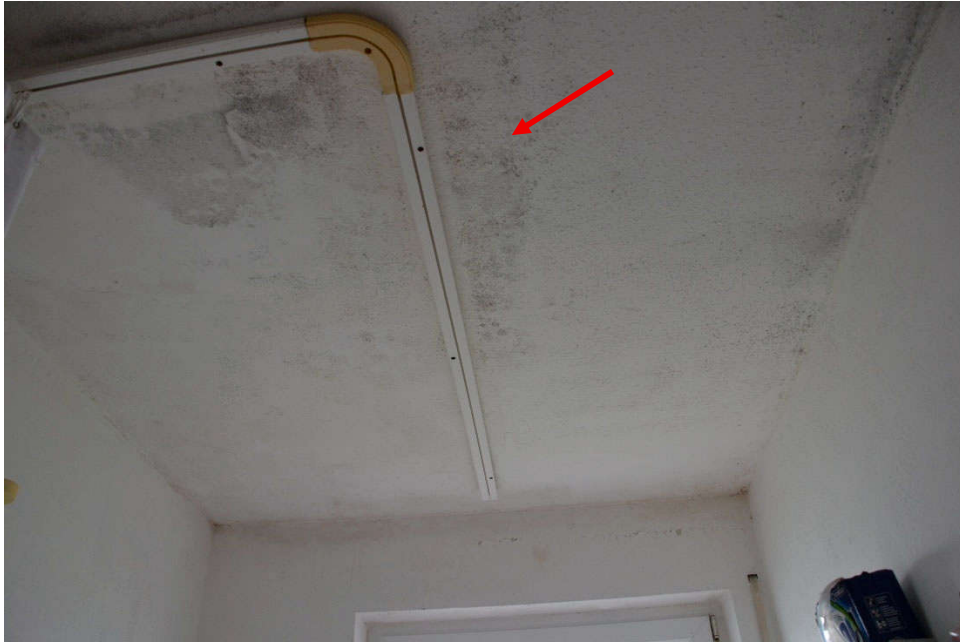
Bild 17: 3. Obergeschoss Bad, Schimmelpilzbefall an Wand/Decke
