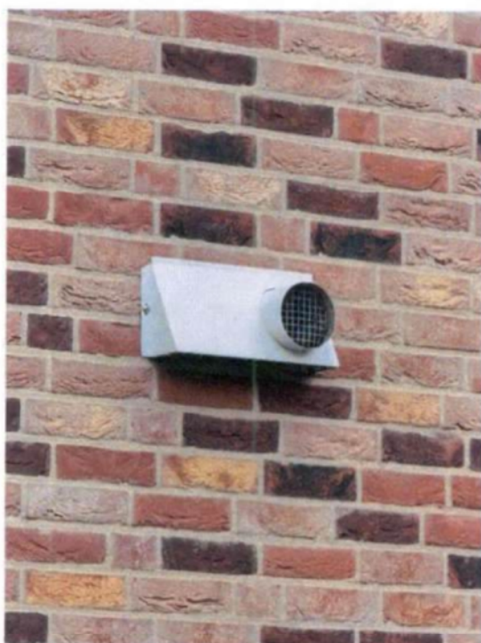
... dezentrale Lüftungsanlage (Hauswirtschaft)
