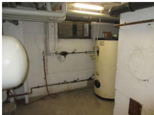
Haustechnik im Keller
