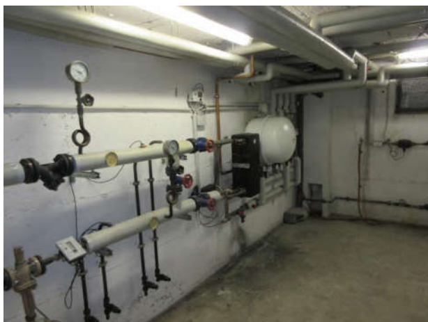
Haustechnik im Keller
