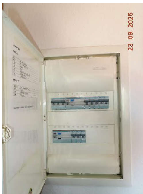
Bild 6: Sicherungskasten der Wohnung im Dachgeschoss
