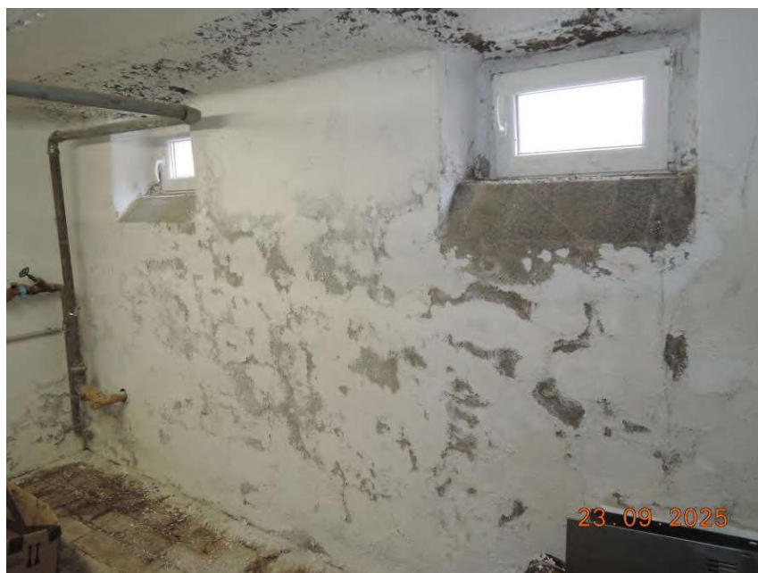
Bild 16: Feuchtigkeitsschäden im Kellergeschoss
