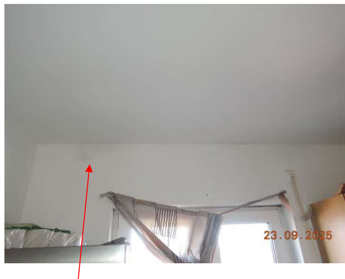
Bild 9: Feuchtigkeitsschäden in der Wohnung im Dachgeschoss
