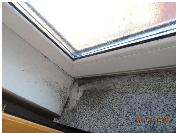
Bild 8: Feuchtigkeitsschäden in der Wohnung im Dachgeschoss
