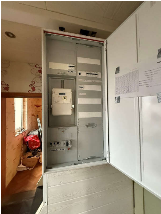
Sicherungskasten mit Zähler PV- Anlage
