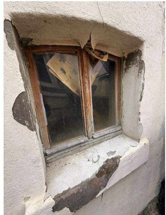
Holzfenster Nebengebäude / Putzschäden
