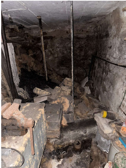
Keller Wohnhaus / erkennbare Feuchtigkeit
