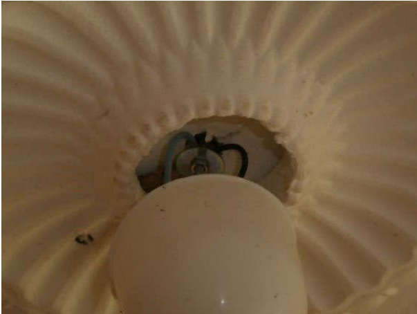
Stichprobe Deckenauslass, kein Schutzleiter
