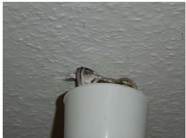
2. Stichprobe Deckenauslass, kein Schutzleiter
