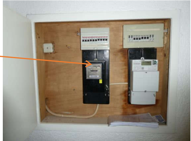
Zähler und Sicherungen außerhalb der Wohnung
