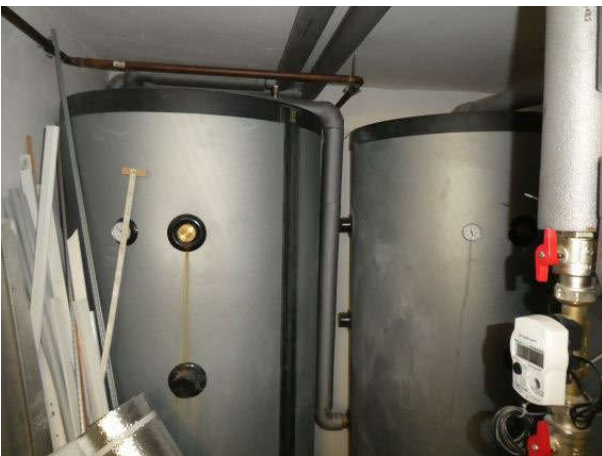
Insgesamt drei Warmwasserspeicher der Solarthermieanlage
