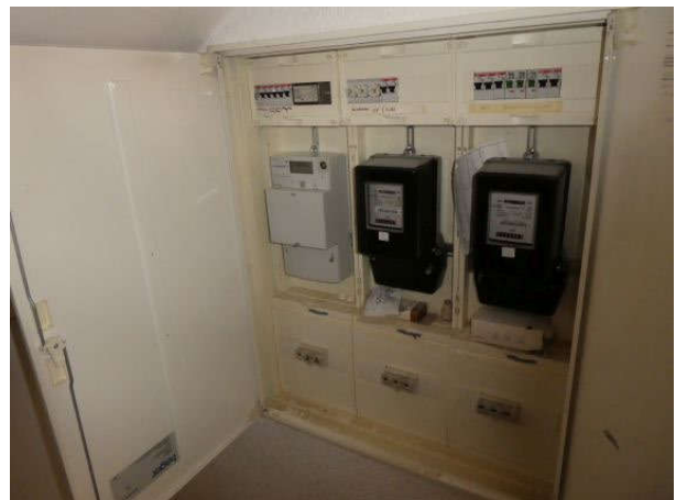
Hauptsicherungen und Zählerkasten im Erdgeschoss
