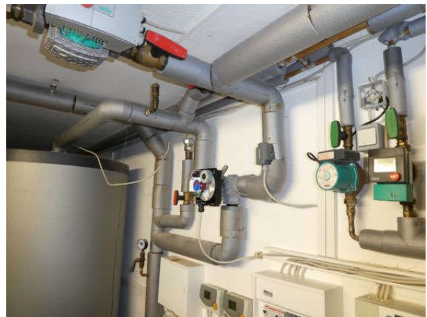
Verrohrung, Dämmung wärmeleitender Rohre vorhanden
