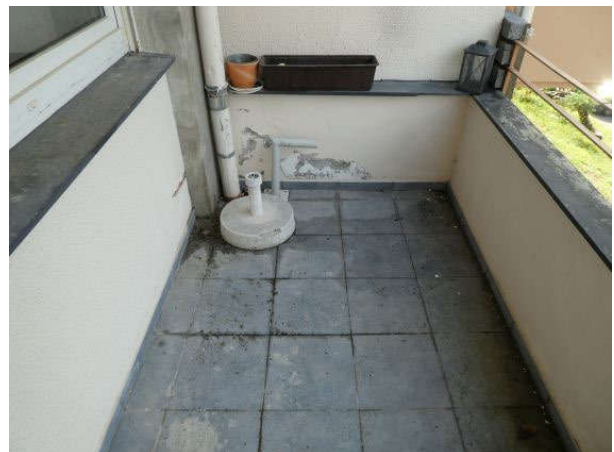
Balkon, Fliesenbelag, Putzschäden erkennbar
