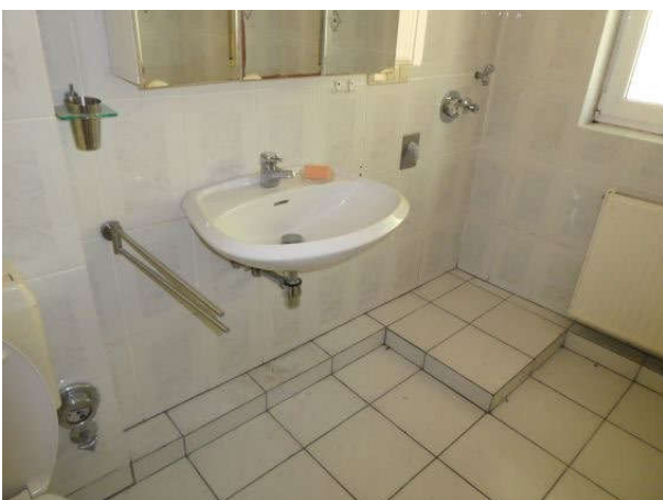
Waschbecken, Standort der Waschmaschine
