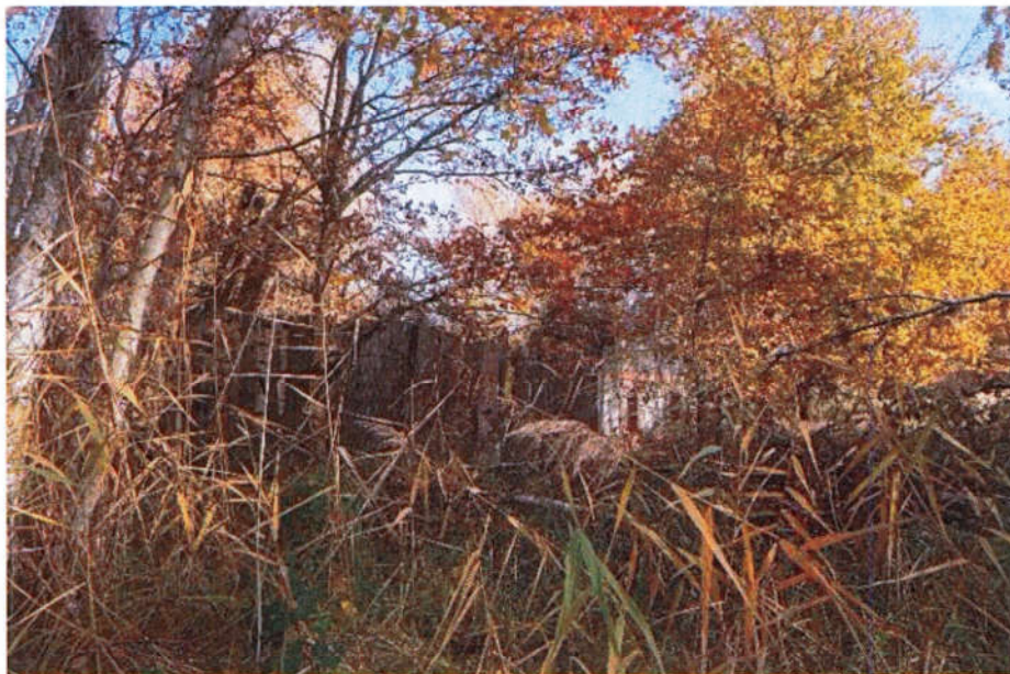
Bild 4: westlicher Grundstücksbereich mit ruinösen Bauresten eines alten Schuppens
