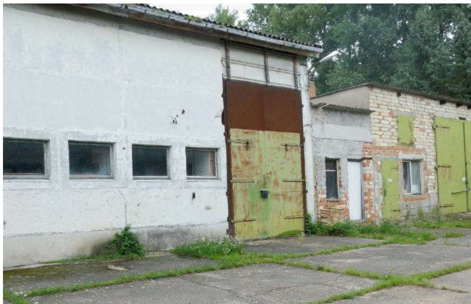
Foto 10, Lagergebäude (Geb. 1), schlechter baulicher Zustand, Südwestansicht
