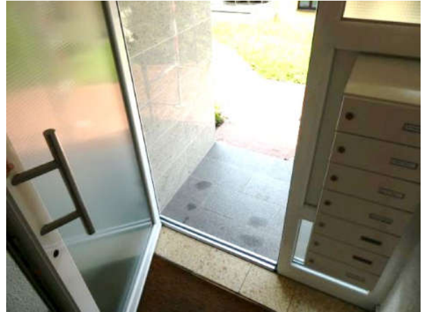
Eingangelement mit Briefkastenanlage
