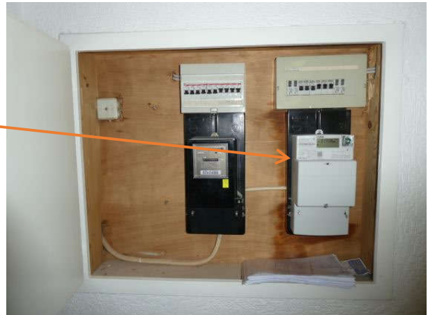
Zähler und Sicherungen außerhalb der Wohnung
