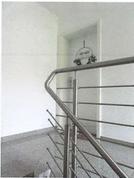
Abschlussstür Wohnung Nr. 2
