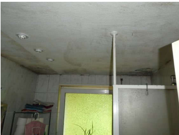
Schäden an Decke im Badezimmer
