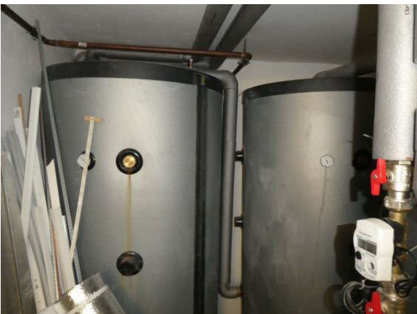
Insgesamt drei Warmwasserspeicher der Solarthermieanlage
