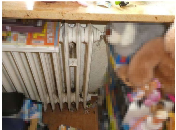
Heizkörper im Wohnzimmer
