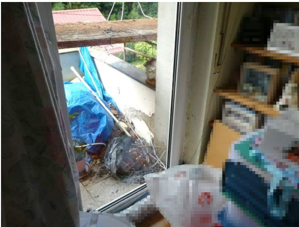
Blick vom Wohnzimmer zum Balkon, Putzschäden erkennbar
