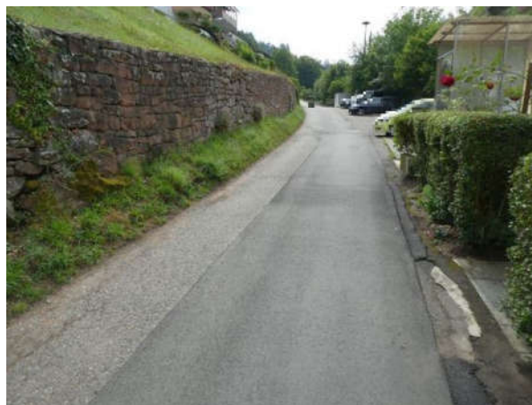
Abb. zeigt aktuellen Zustand der Straße
