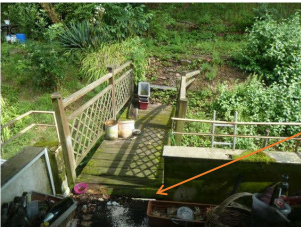
Brücke stark verwittert
