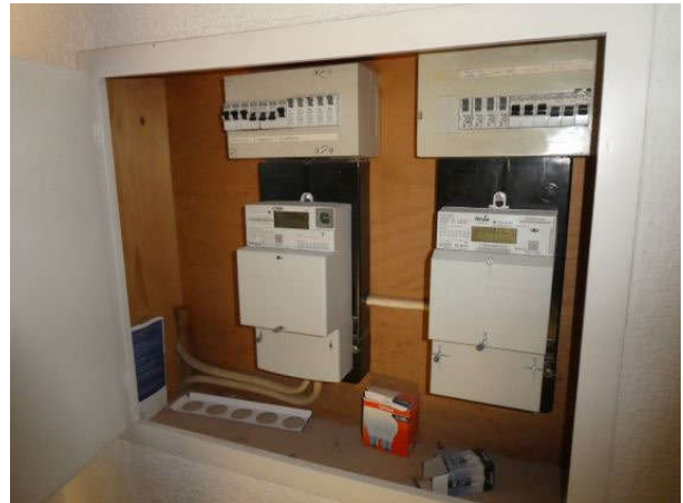
Zähler und Sicherungen außerhalb der Wohnung
