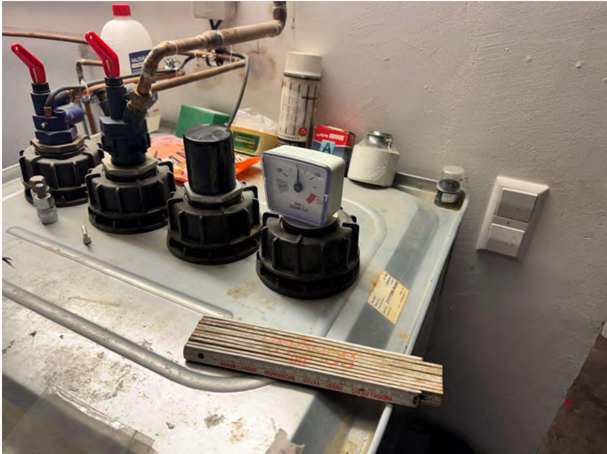
Abbildung 38 Puffertank und Pumpenanlage
