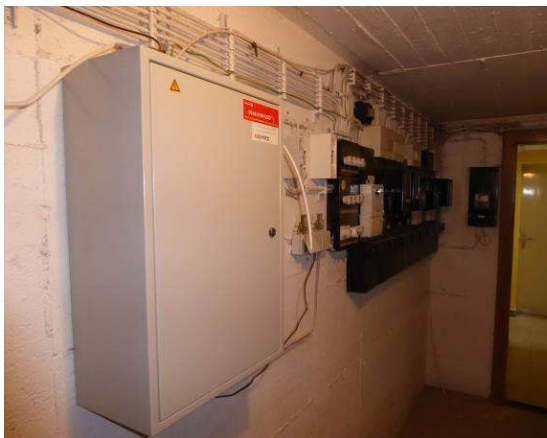
11. Stromzähler im Kellerflur (soll erneuert werden)
