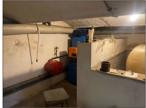
Bild 20: Kellerraum mit Ölheizung
