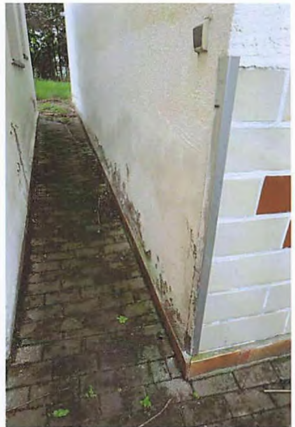
Feuchteschadensbilder im Sockelbereich
