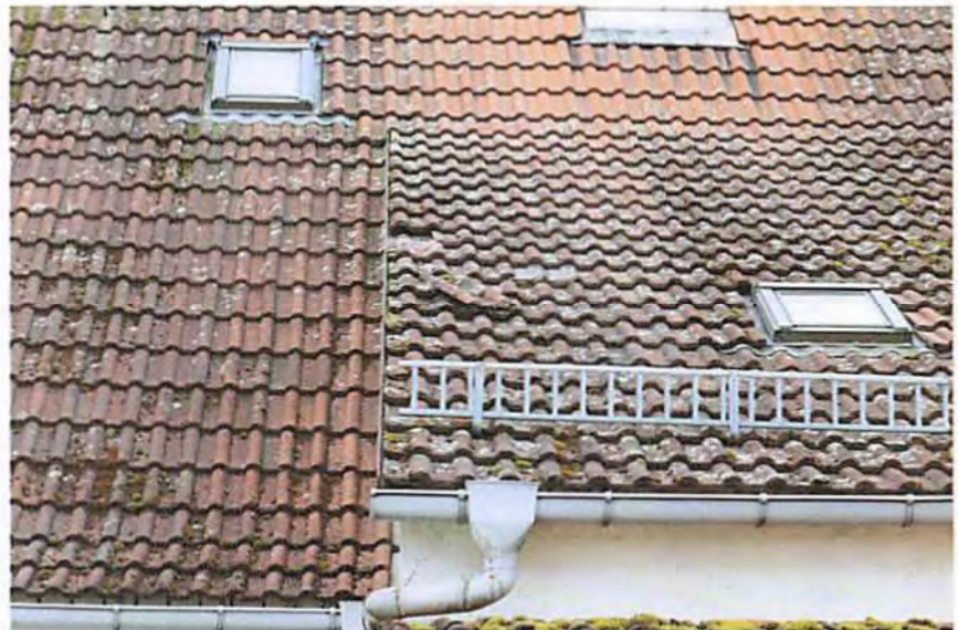
Sichtschaden in der Dacheindeckung
