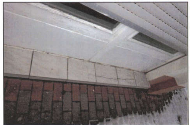
Fliesung Außenfensterbänke schadhaft
