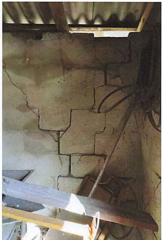
Großflächige Sichtschäden (Statik prüfen)
