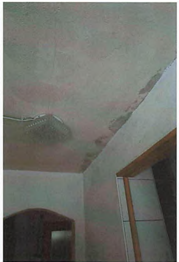
Sichtschäden im Deckenbereich
