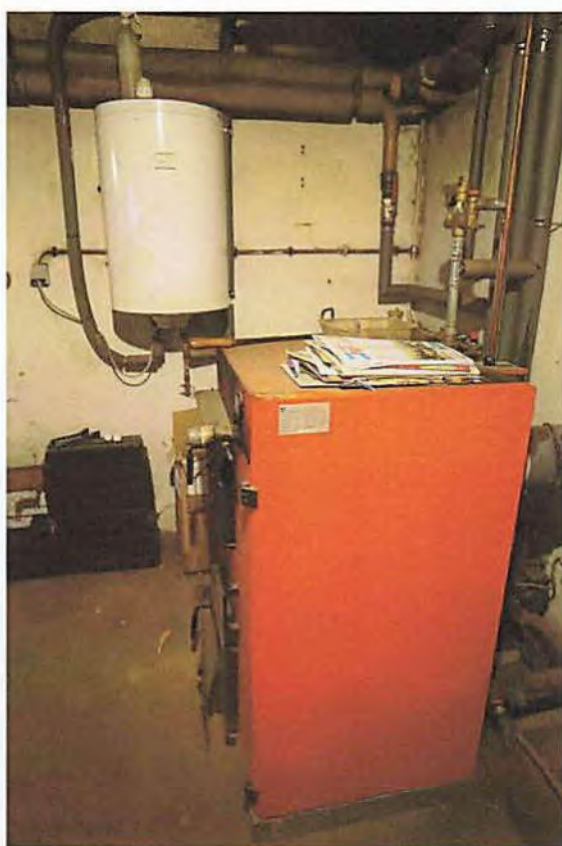
Heizungsanlage für feste Brennstoffe
