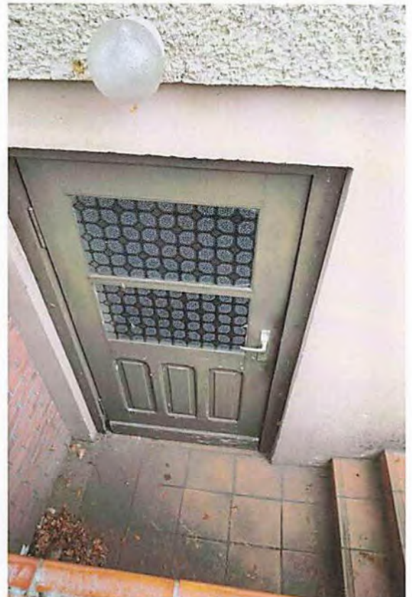
Außenkellertür (Versicherungsschutz prüfen)
