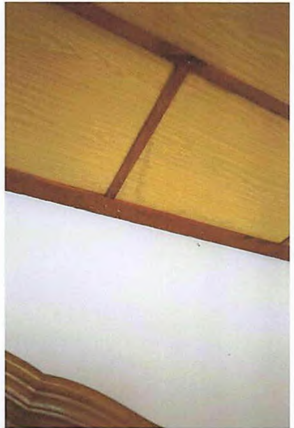
Sichtschäden im Deckenbereich
