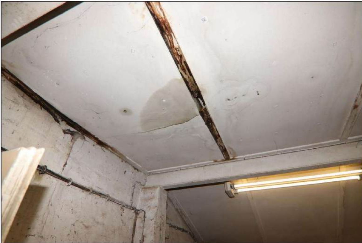
Blick auf eine Deckplatte mit Durchfeuchtungerscheinungen. Hier scheint seit längerer Zeit Niederschlagswasser einzudringen.
