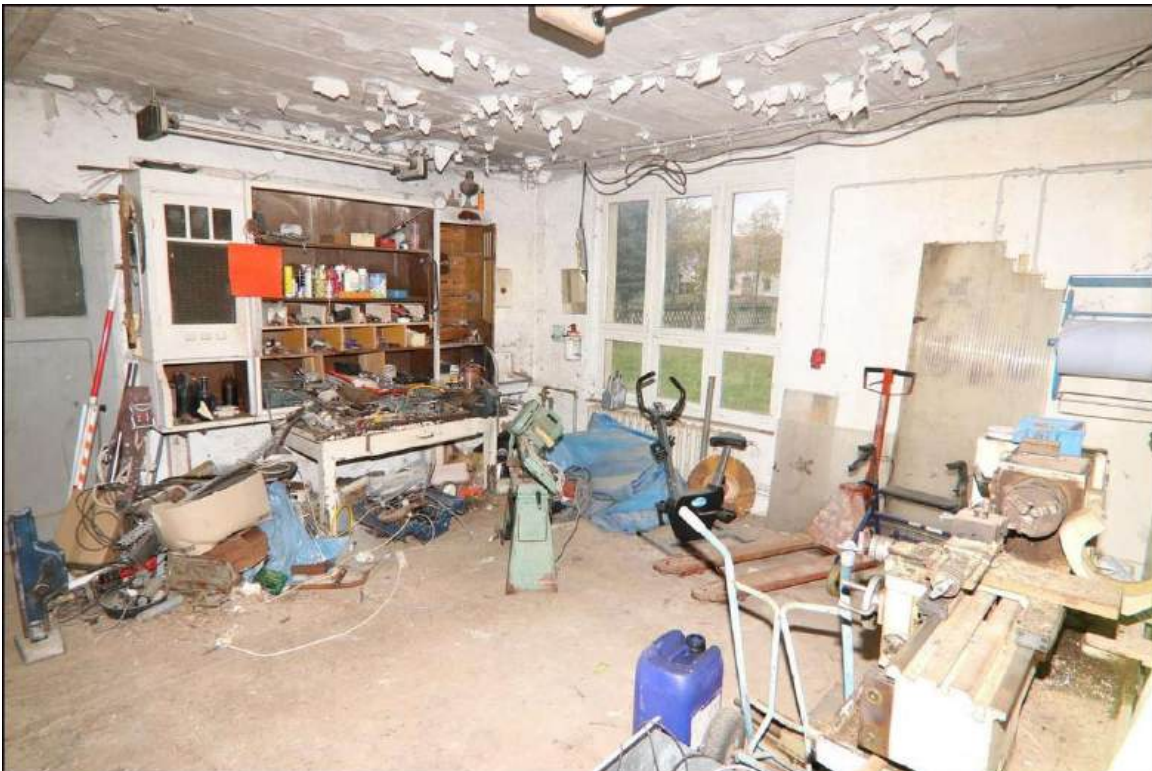
Blick in den Lagerraum im mittleren Teil des Werkstattgebäudes. Unter den Holzfenstern wurden Rippenheizkörper installiert. Die Decke ist massiv ausgeführt. Hier platzt die Farbe teilweise ab. Der Fußboden besteht massiv aus Beton.
