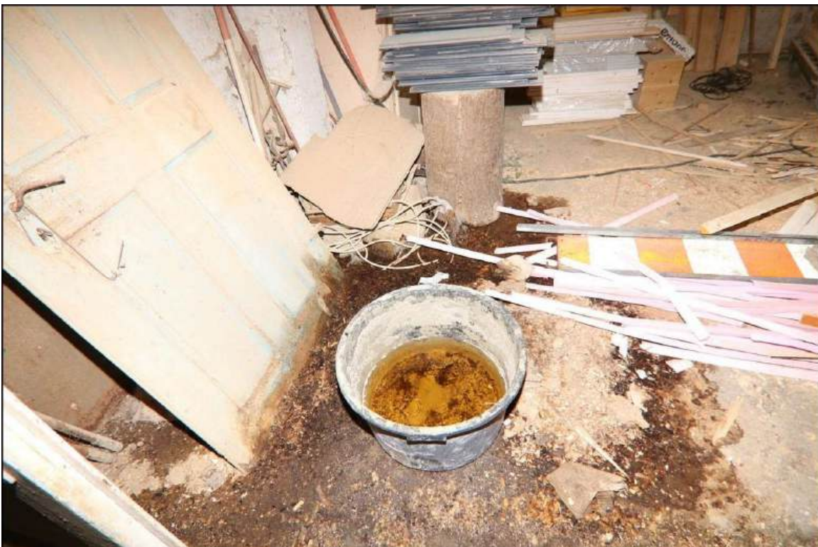
Blick auf dem Bereich unterhalb der Einlaufstelle. Hier ist viele Jahre Niederschlagswasser eingesickert.
