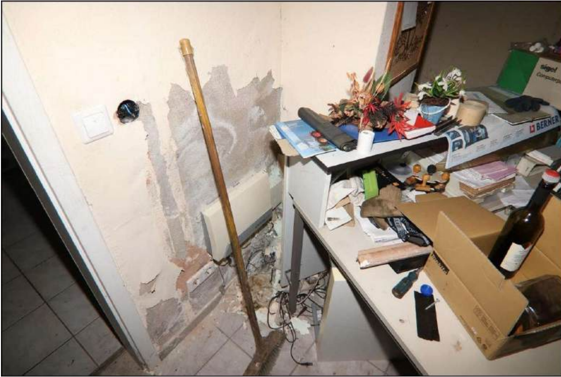
Blick in eine Ecke neben dem Eingang zum Büro mit massiven Anzeichen von aufsteigender Feuchtigkeit. Hier haben sich die Wandfarbe und stellenweise auch der Putz von einer Wand gelöst.
