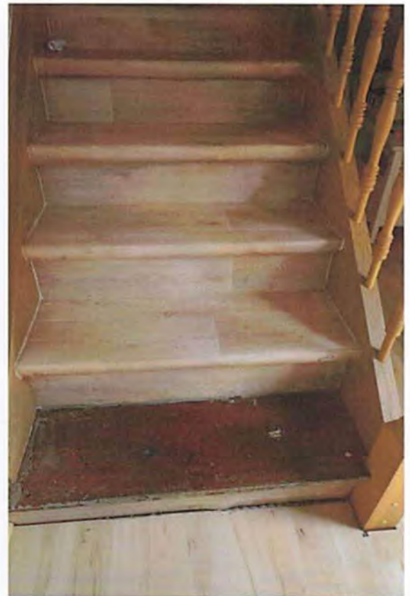
Laienhafte Ausführung der Treppenverkleidung
