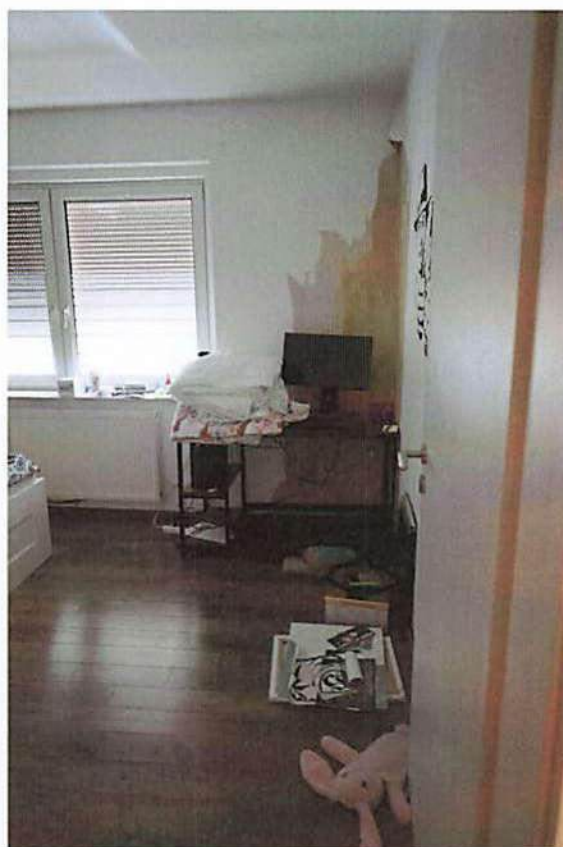
Sichtschäden im Wandanschluss
