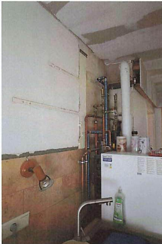
Heizungsanlage in der Küche
