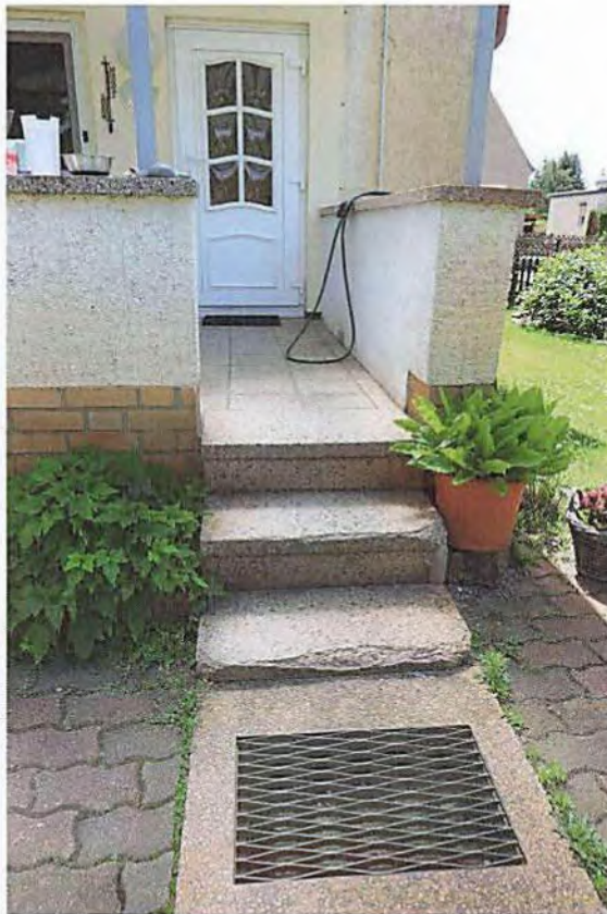
Genutzter Zugang (Sichtschäden an den Treppenstufen)
