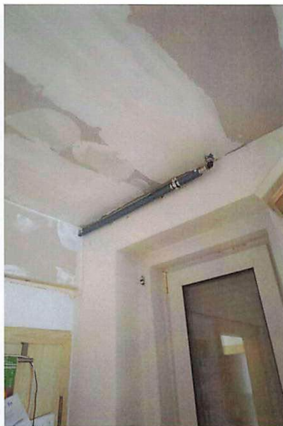
Nicht fertiggestellte Deckenfläche
