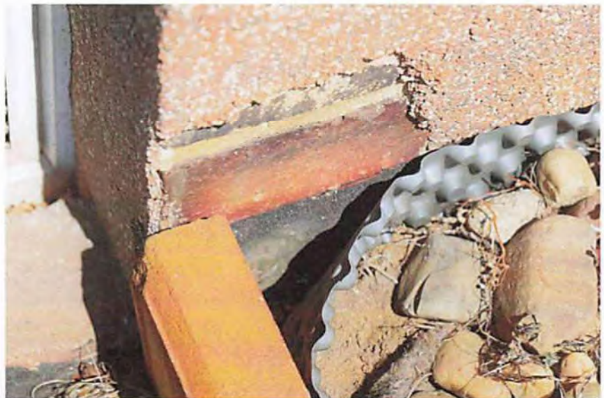
Nicht fachgerechte Bauausführung
