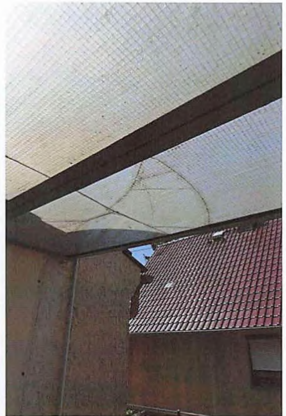
Sichtschäden in der Überdachung
