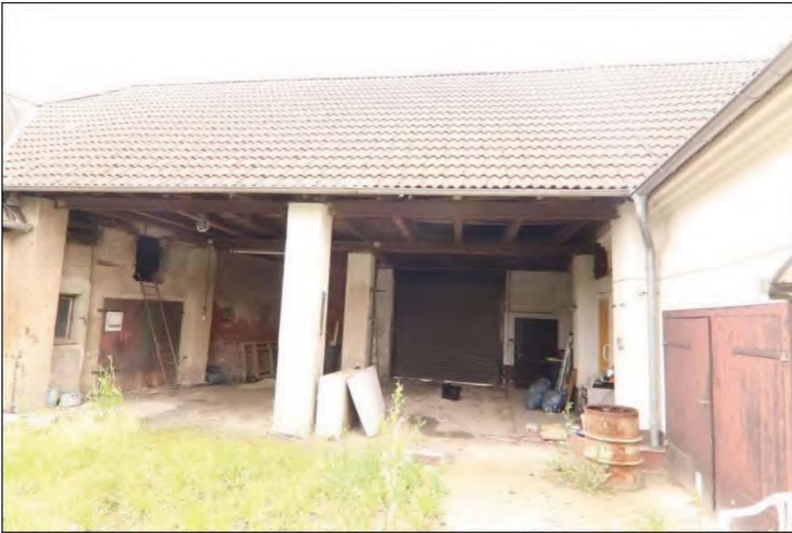
Blick vom Hof in südwestliche Richtung auf die Durchfahrt im Scheunengebäude. Das Dach der Durchfahrt wurde auf massive Stützen gestellt. Die Dacheindeckung besteht aus Dachziegeln. Im Hintergrund sind das Zufahrtstor sowie die Eingangstür gut erkennbar.
