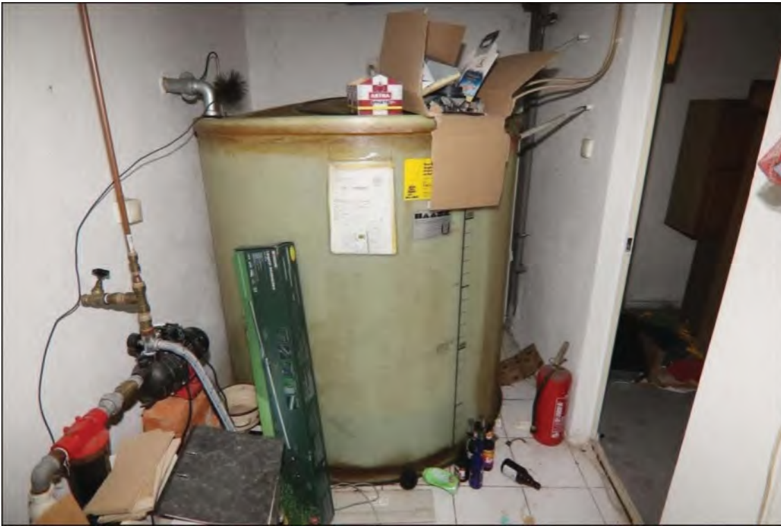
Rückwärtiger Blick in den Heizungsraum mit dem dazugehörigen Öltank. Der Tank hat ein Fassungsvermögen von etwa 2.500 Litern. Die Tür auf der rechten Seite führt in den Flur 2.
