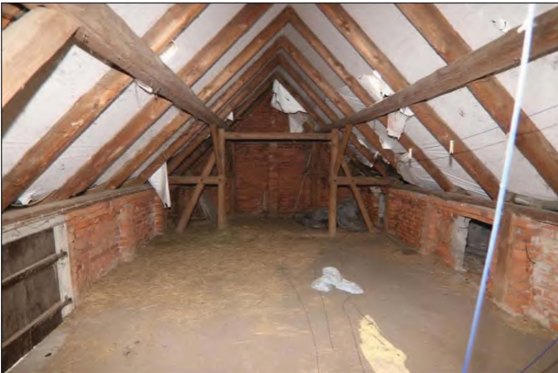
Blick in südliche Richtung auf den Dachboden des Wohnstallhauses. Das Dach liegt als Satteldach vor und wurde von innen mit Unterspannbahnen versehen. Auch die Holzbalken der Dachkonstruktion sind hier gut erkennbar.
