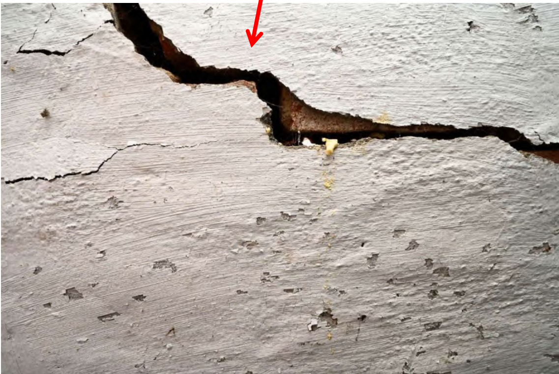
Abb. 28: Nebengebäude B, Erdgeschoss, Werkstatt, Detail Mauerwerksriss (zu Trocken-WC)
