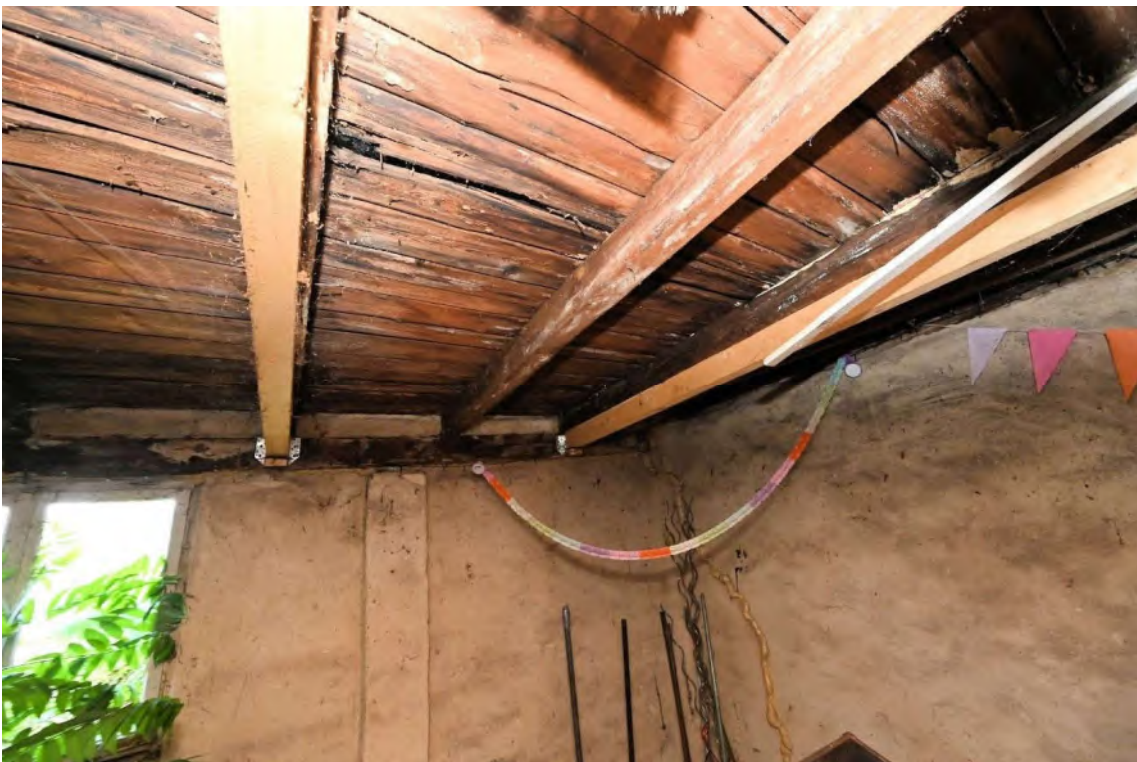
Abb. 32: Nebengebäude C, Erdgeschoss, Detail Nässeschäden
