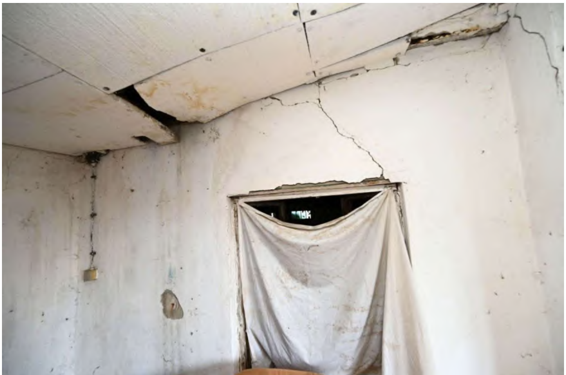
Abb. 34: Nebengebäude D, Erdgeschoss, Fenster zu Gebäude C, Detail Einregenschaden und Rissbildung
