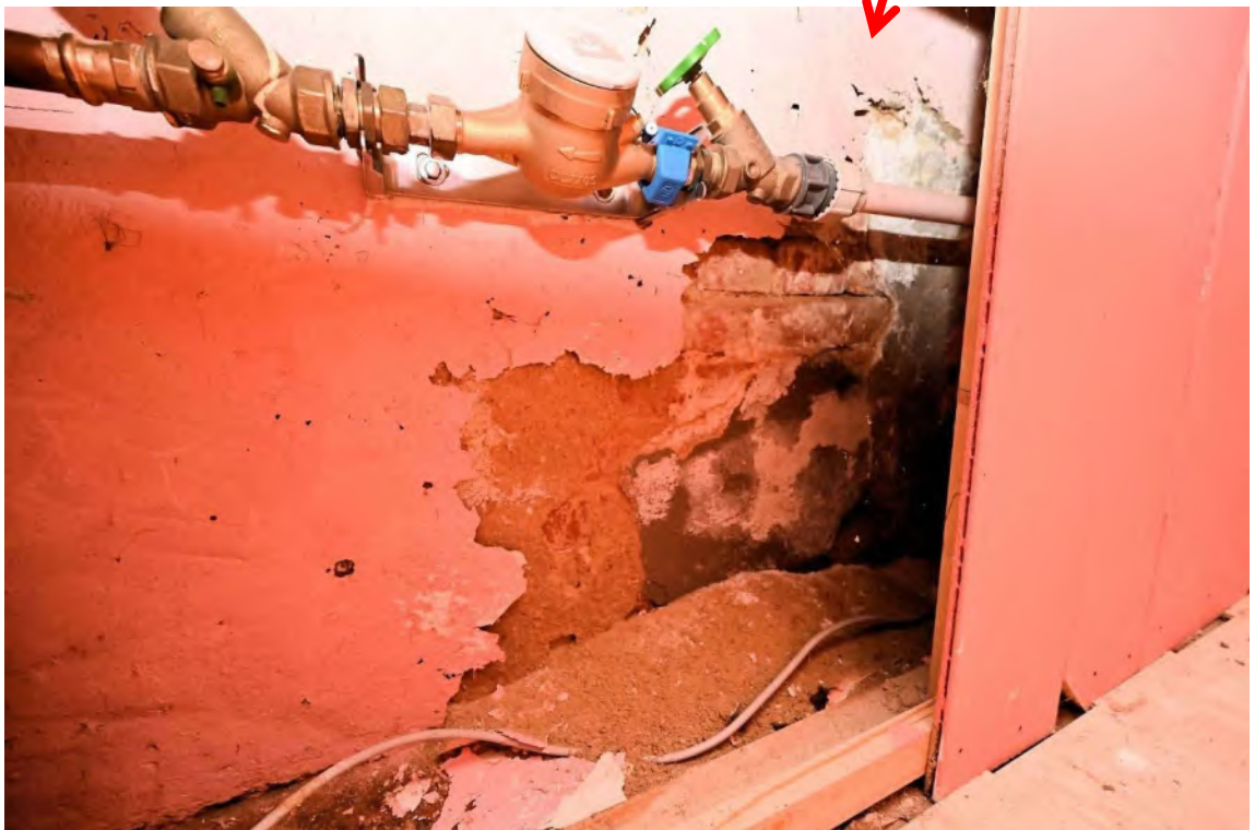
Abb. 10: Gebäude A, Teilkeller, Detail Absandungen
