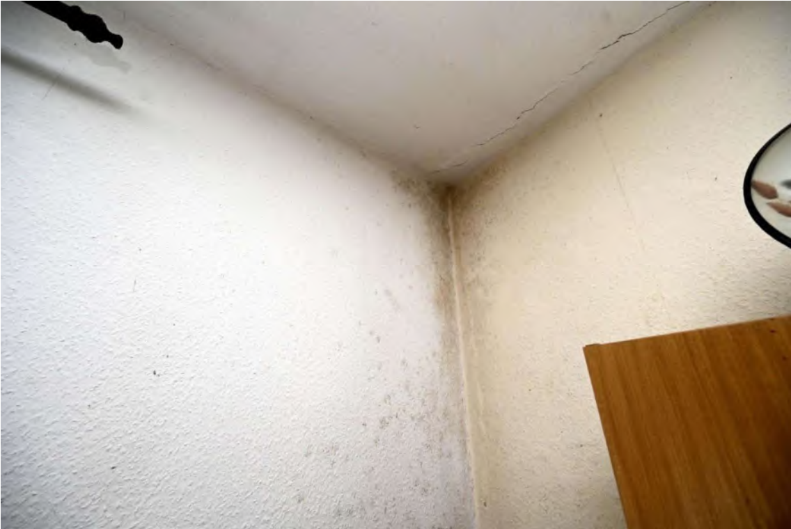
Abb. 15: Gebäude A, Erdgeschoss, Wohnzimmer, Detail Nässeschaden u. a. X-sel Außenwand
