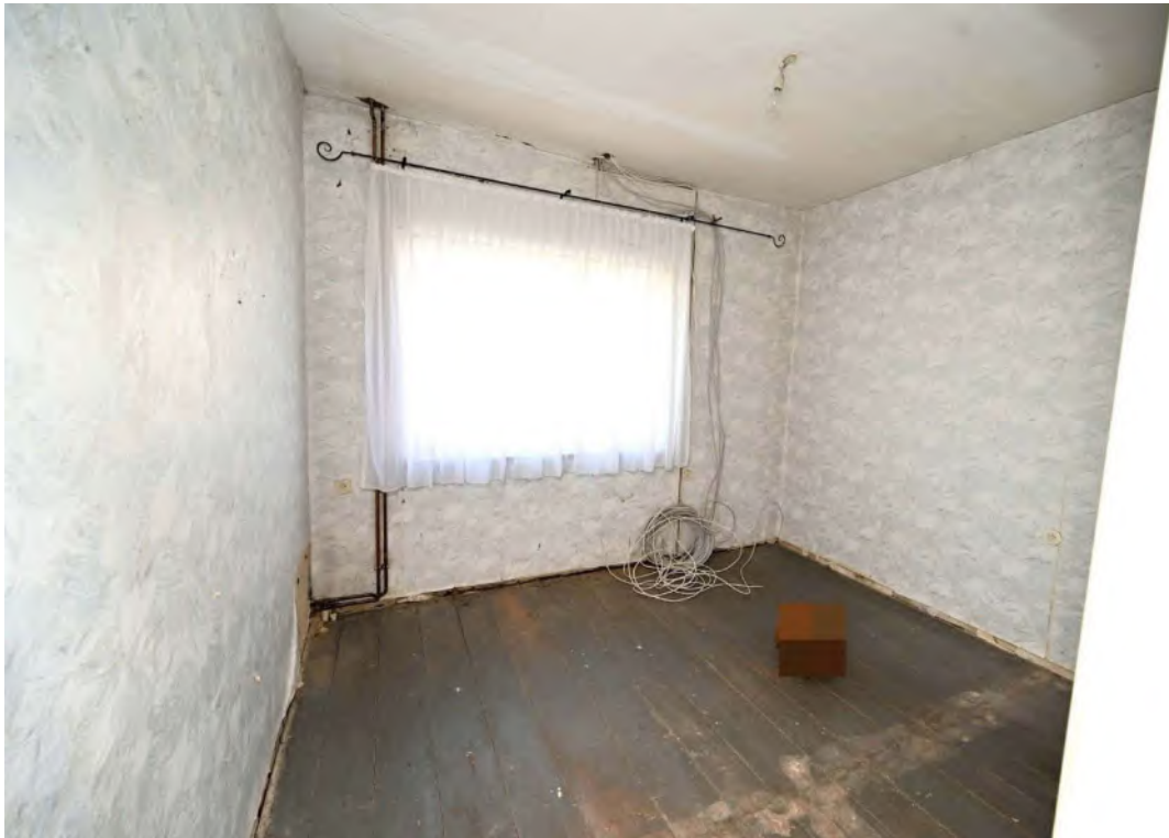
Abb. 13: Gebäude A, Erdgeschoss, Zimmer 2, u. a. Leitungsführung auf Putz
