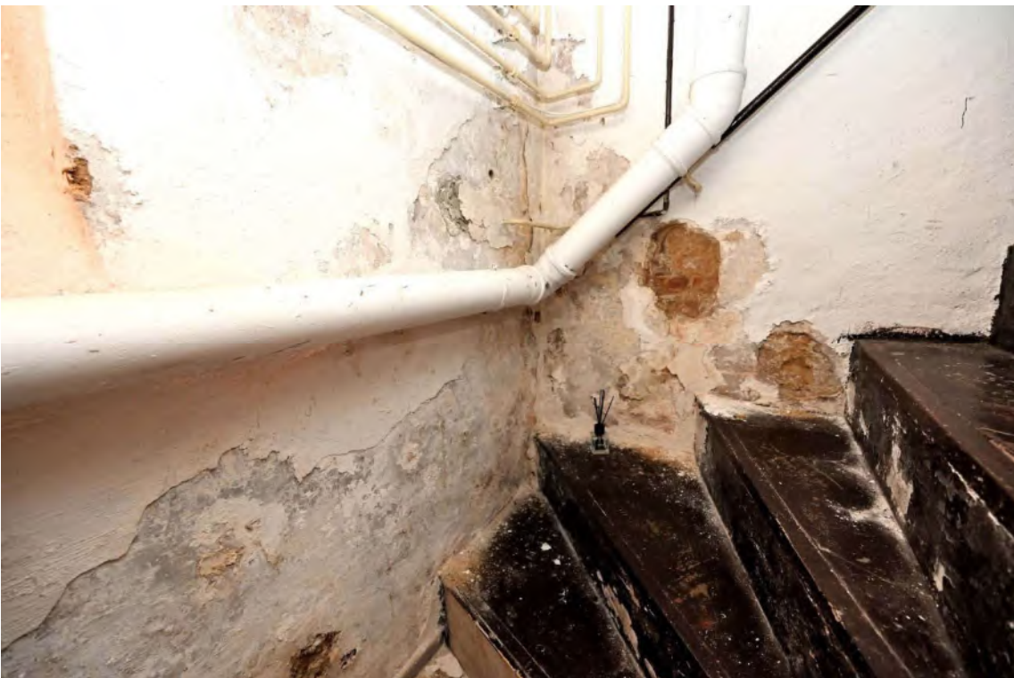
Abb. 8: Gebäude A, Teilkeller, Detail Mauerwerksfeuchte und Putzschäden
