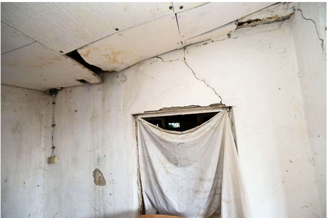
Abb. 34: Nebengebäude D, Erdgeschoss, Fenster zu Gebäude C, Detail Einregnungsschaden und Rissbildung
