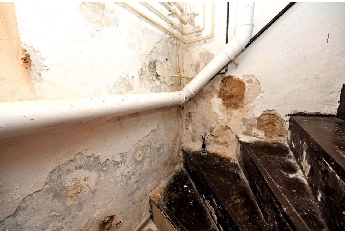
Abb. 8: Gebäude A, Teilkeller, Detail Mauerwerksfeuchte und Putzschäden
