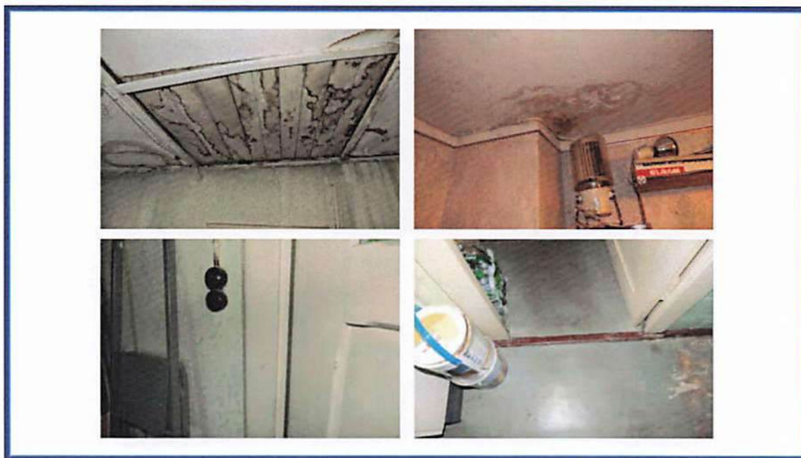
Abbildung 7: Küche; einfache und überalterte Ausstattung; Wassereinflaufspuren durch eine beschädigte Dacheindeckung
