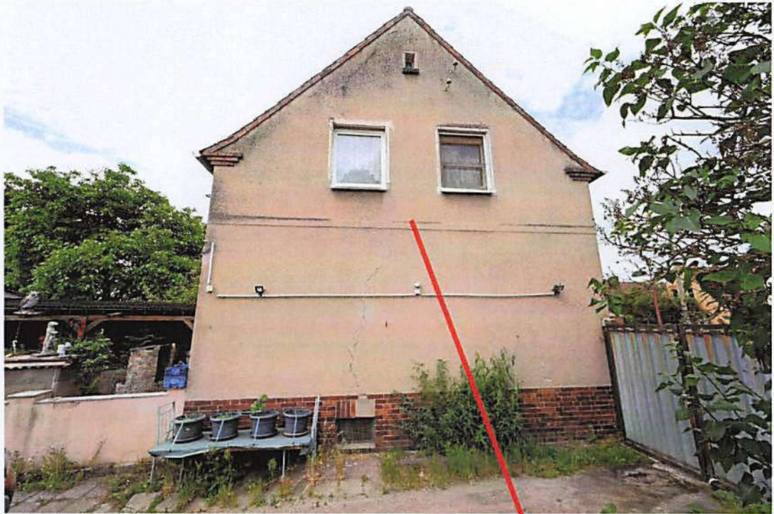
Abb. 5: südlicher Giebel Wohnhaus (A), Risse
